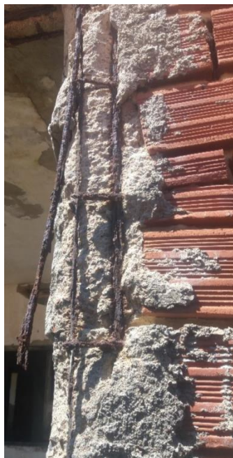
Figura 3 – Armadura exposta na amostra 2.
