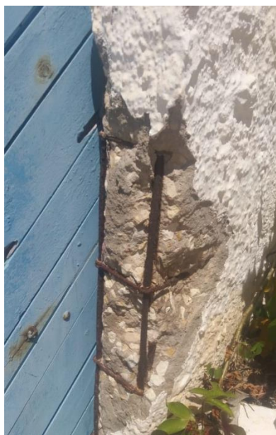
Figura 6 – Efeito corrosivo na terceira amostra.
