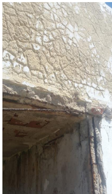
Figura 4 - Corrosão na amostra 2.
