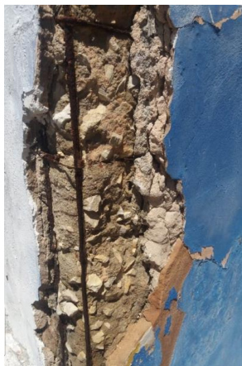
Figura 2 – Efeito corrosivo em estrutura da amostra 1.
