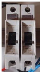
Figura 6. Disjuntores. (Autoria própria)
