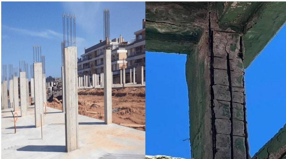
Figura 13 - Comparação entre uma estrutura saudável e outra deteriorada
