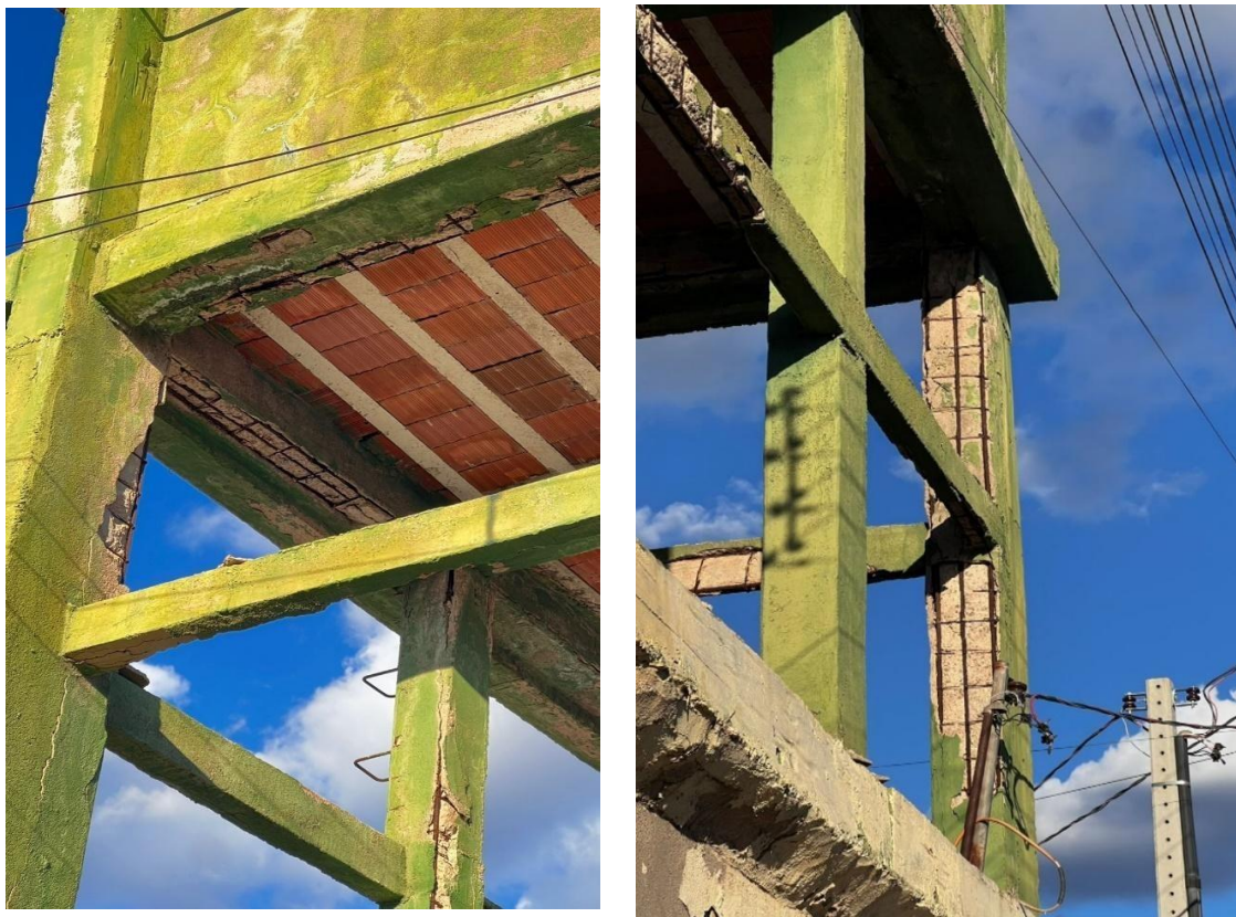
Figura 11 - Registros fotográficos do deslocamento e das fissuras na caixa d'água no dia 26 de maio de 2025
