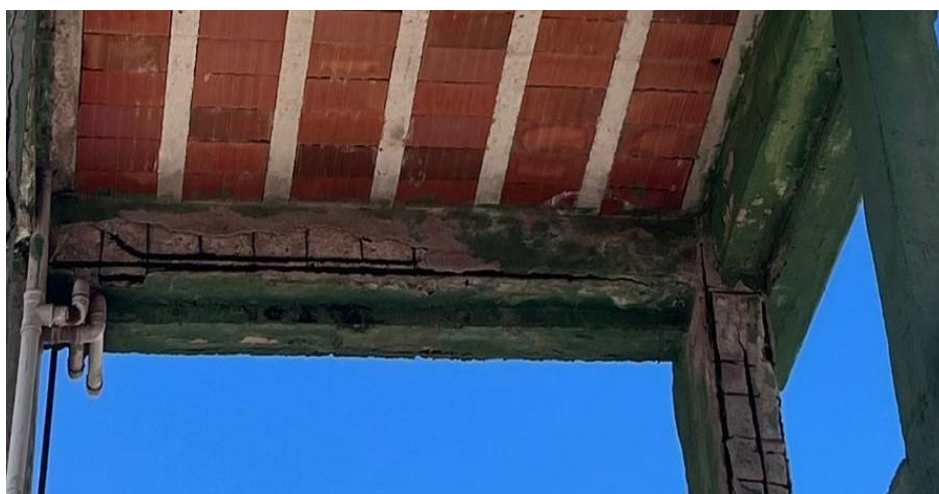
Figura 10 - Registro da estrutura com baixo cobrimento e umidade do dia 03 de junho de 2025
