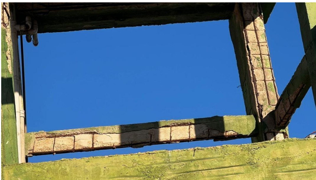
Figura 12 - Registro fotográfico do deslocamento e de fissuras na caixa d'água
