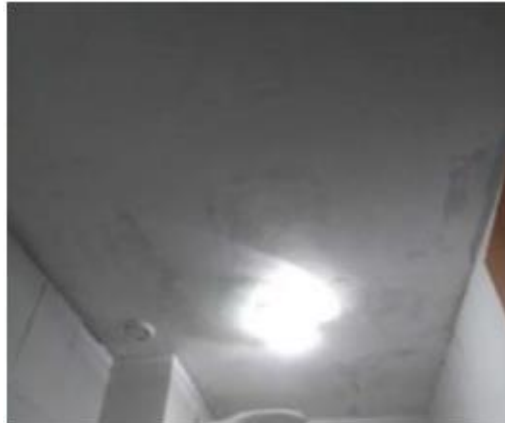
Figura 07 - Infiltrações no teto.
