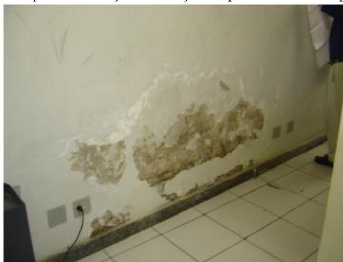
Figura 02 – Umidade por condensação, infiltração em parede devido a ruptura de tubulação.
