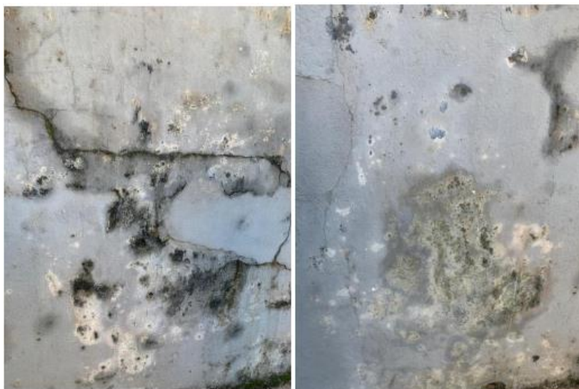
Figura 09 - Mofo e bolor (respectivamente) em uma obra devido à falta de impermeabilização.
