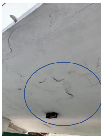
Figura 10 - Formação de bolhas em uma obra devido à falta de impermeabilização.
