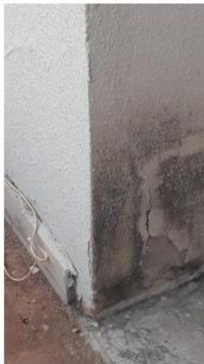
Figura 08 - Erupção da tinta e início de desestruturação do reboco
