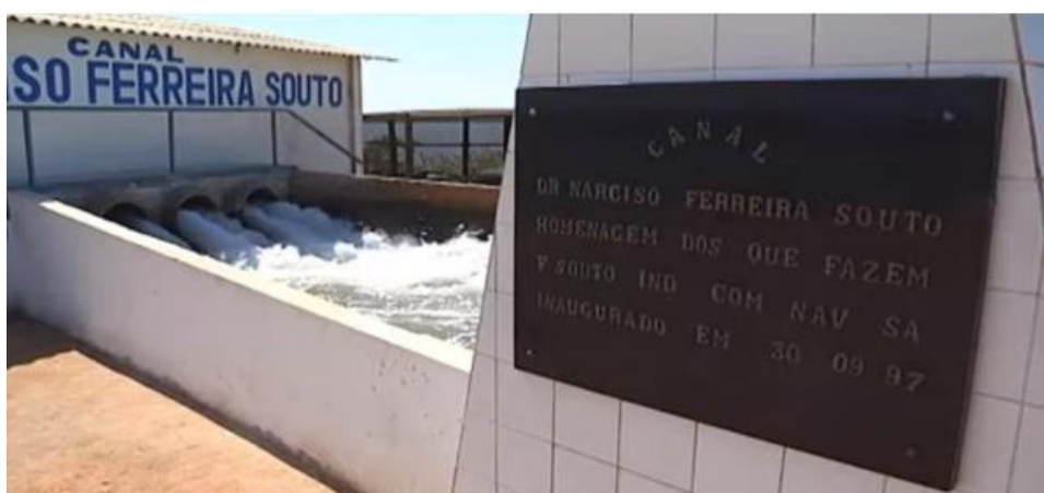
Figura 4: Estação de bombeamento
