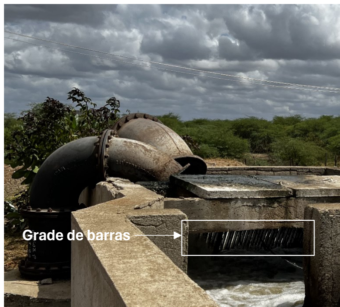
Figura 8 - Tratamento preliminar por gradeamento na Estação de Tratamento de Esgoto Cajazeiras, inserida no município de Mossoró-RN
