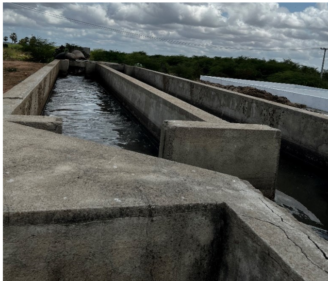
Figura 9 - Tratamento preliminar por caixa de areia na Estação de Tratamento de Esgoto Cajazeiras, inserida no município de Mossoró-RN
