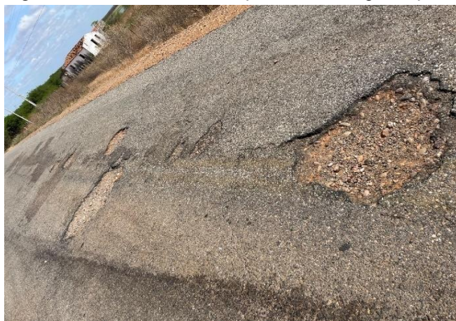
Figura 3 - Processo de deterioração da RN-233, presença de panelas.
