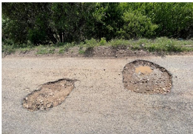
Figura 1 - Buracos em um dos trechos críticos que ligam Apodi à Caraúbas, pela RN-233.
