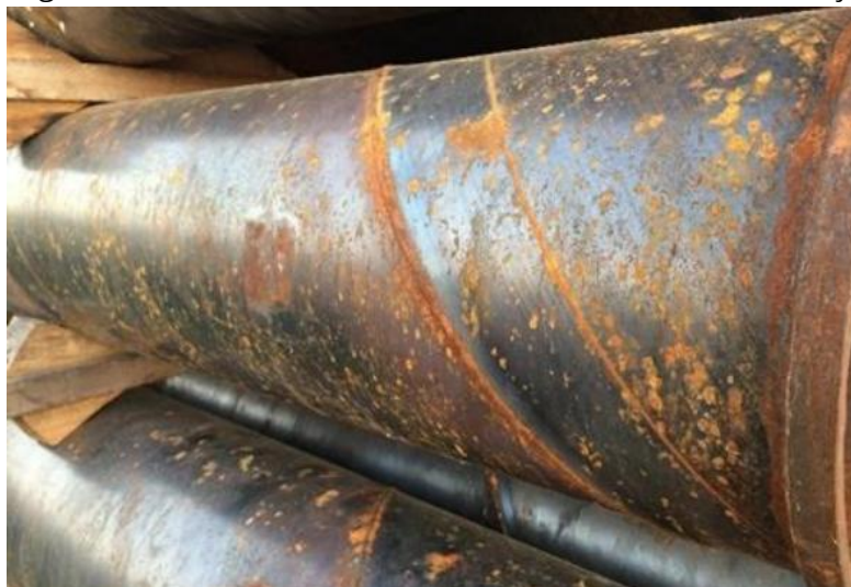
Figura 8 - Corrosão em torno do cordão de solda na tubulação.
