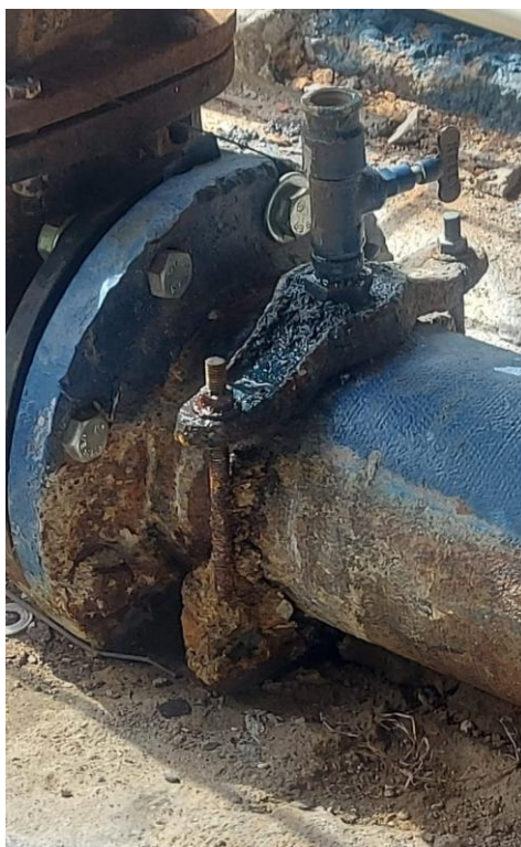
Figura 20 - Corrosão diferencial em tubulação parcialmente enterrada.
