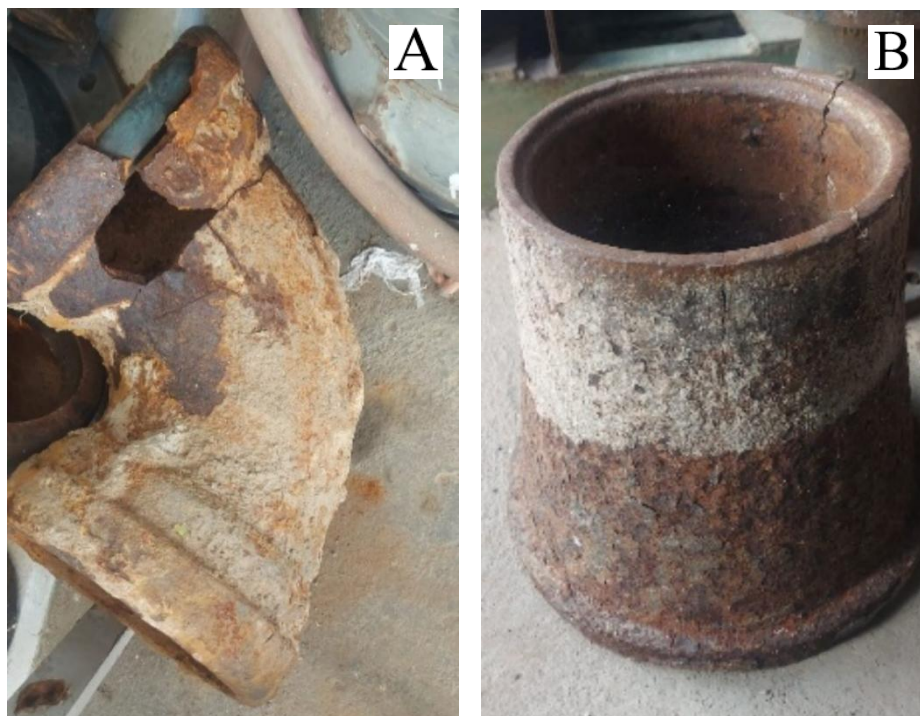
Figura 17 – Componente com corrosão uniforme: (A) joelho metálico de 90°; (B) caixa de registro.
