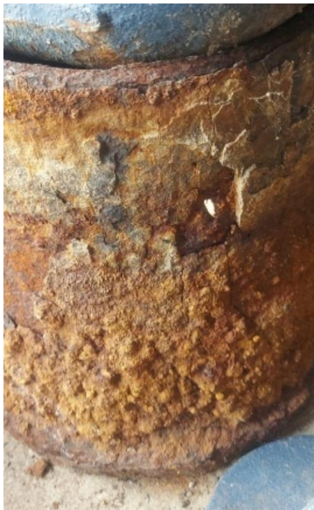
Figura 18 - Corrosão por placas em caixa de registro.
