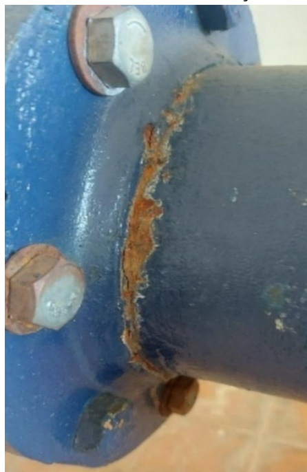
Figura 19 - Corrosão em torno de cordão de solda em tubulação.
