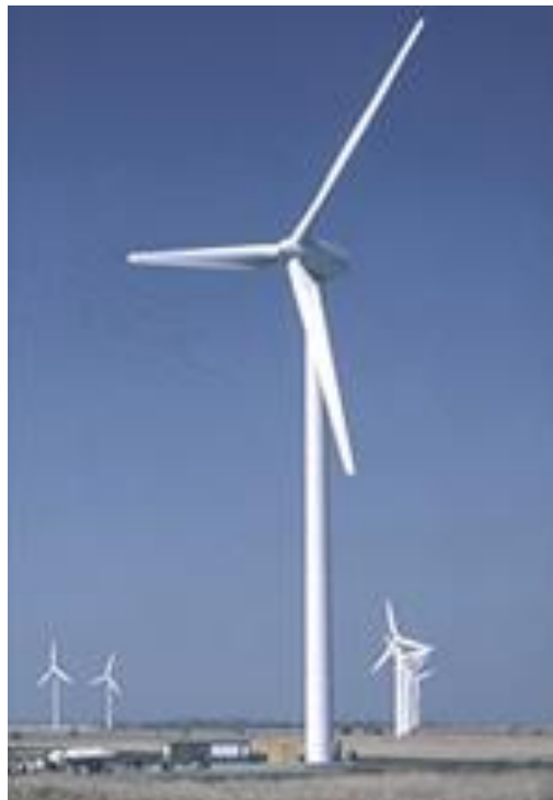
Figura 4: Aerogerador de eixo horizontal.
