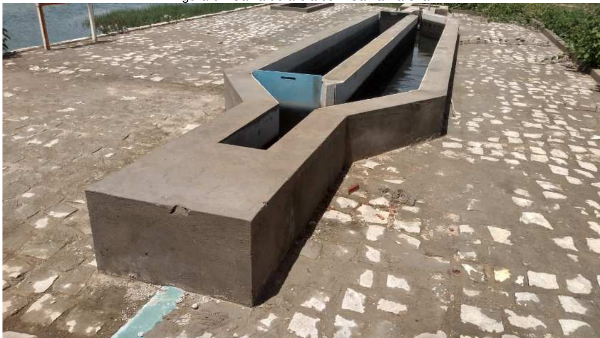
Figura 6 - Caixa de areia com Calha Parshall
