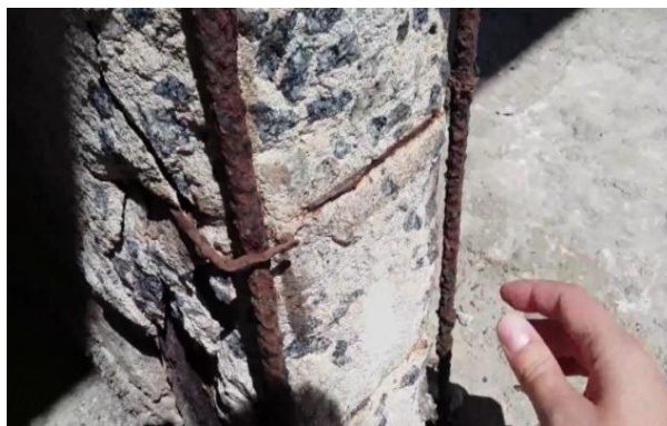
Figura 4: Corrosão da armadura.
