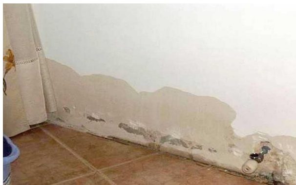
Figura 9: Manchas por umidade.
