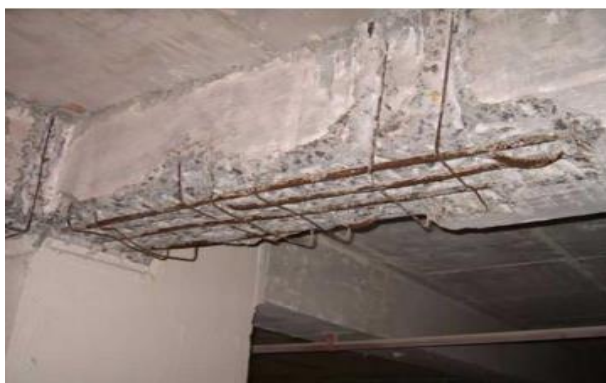
Figura 5: Desagregação do concreto.
