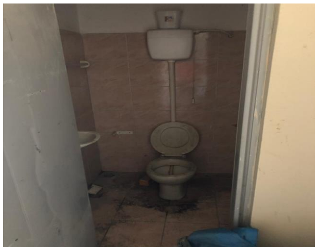
Figura 15: Banheiro dos Eletricistas
