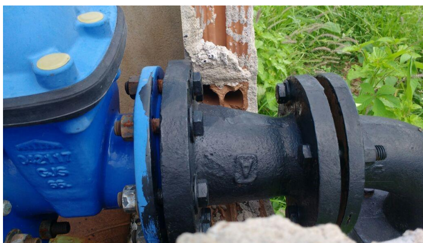
Figura 12 – Parafusos de fixação, localizada no início da cidade de Pau dos Ferros-RN, Bairro João XXIII (23)
