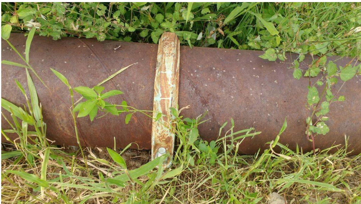
Figura 11 – Braçadeiras de junção da tubulação, localizada no início da cidade de Pau dos Ferros-RN, Bairro João XXIII (23)
