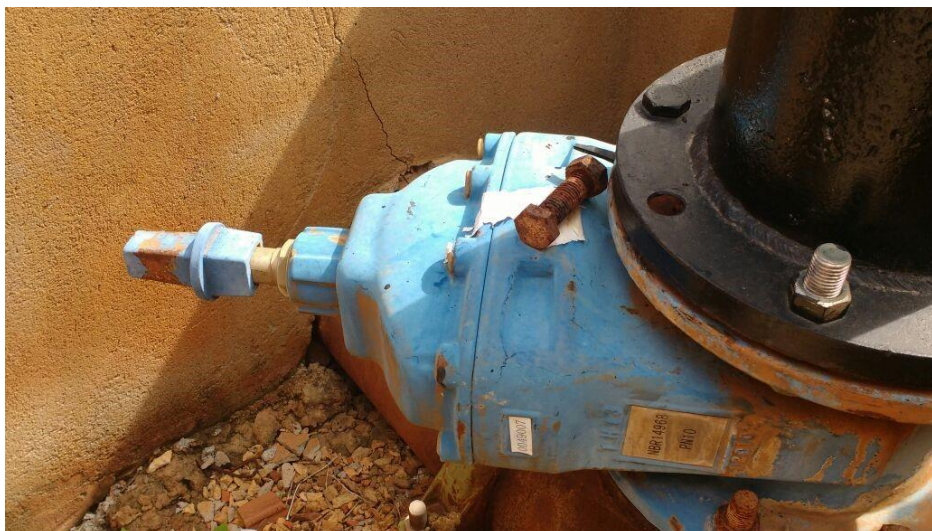
Figura 14 – Válvula de gaveta da adutora, localizada no início da cidade de Pau dos Ferros-RN, Bairro João XXIII (23)
