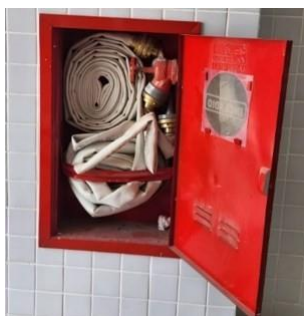
FIGURA 6. Hidrante do Centro de Engenharia, faltando as chaves de engate.
