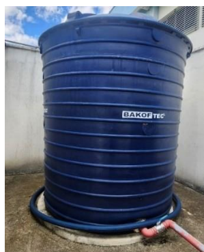
FIGURA 9. Reservatório do tipo ao nível do solo localizado no Prédio Administrativo II.
