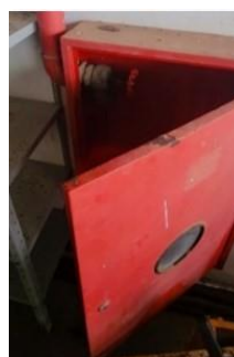
FIGURA 7. Hidrante do Setor de Transporte, todos os abrigos estavam vazios.
