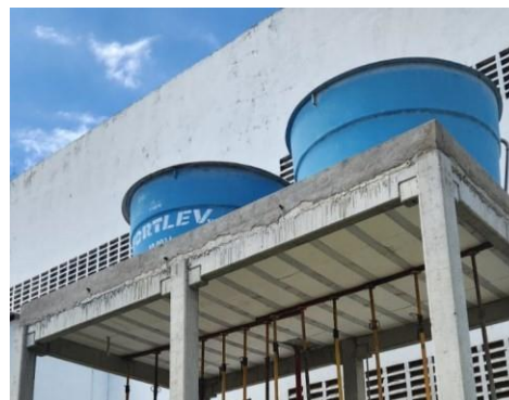
FIGURA 10. Reservatório do tipo elevado localizado no Prédio Expocenter.
