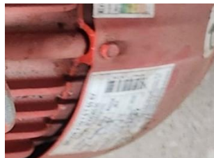
FIGURA 3. Etiqueta danificada da bomba centrífuga localizada no prédio NPSA. Fonte: Foto tirada pela Autora (2025).
