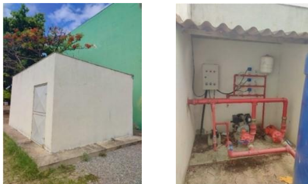
FIGURA 8. Casa de bombas do Prédio Administrativo II. Foto esquerda: Parte externa; Foto direita: Vista interna.
