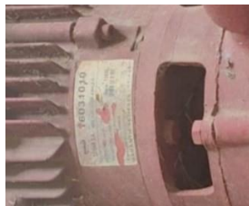
FIGURA 2. Etiqueta danificada da bomba centrífuga localizada no prédio do Setor de Transportes. Fonte: Foto tirada pela Autora (2025).
