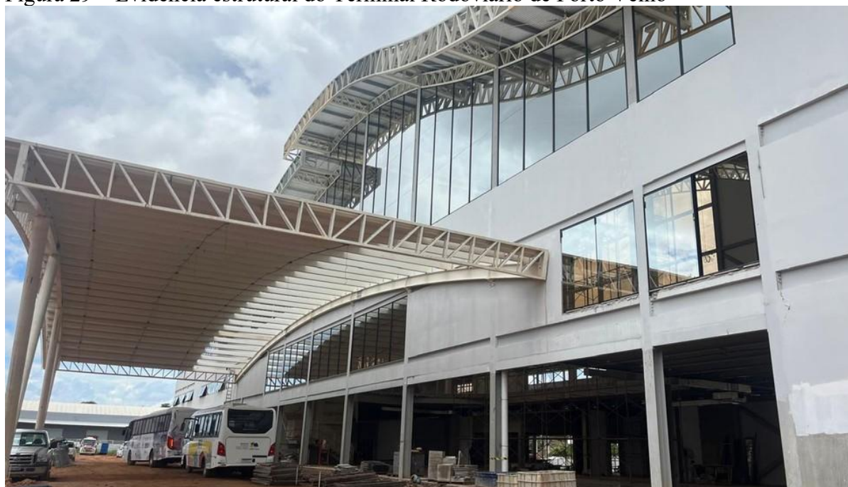
Figura 29 – Evidência estrutural do Terminal Rodoviário de Porto Velho
