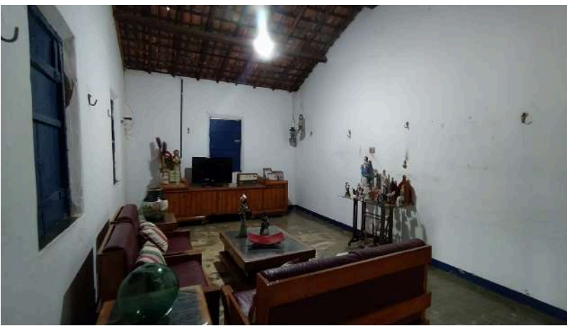
Figura 46: Sala de estar. Elementos: esquadrias preservadas; muitos armadores de ferro; Rodapé destacado com tinta azul. Fonte: Autoria própria, 2025.
