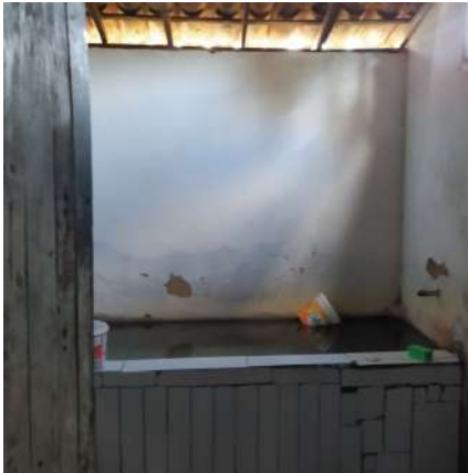
Figura 29: Banheiro. Elementos: tanque de água. Fonte: Autoria própria, 2025.
