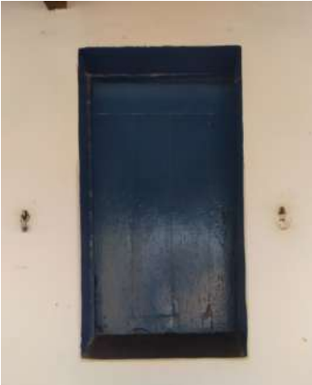
Figura 55: Esquadrias pintadas na cor azul. Fonte: Autoria própria, 2025.
