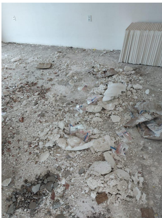
Figura 14 – Resíduos gerados na execução do revestimento de gesso na obra A
