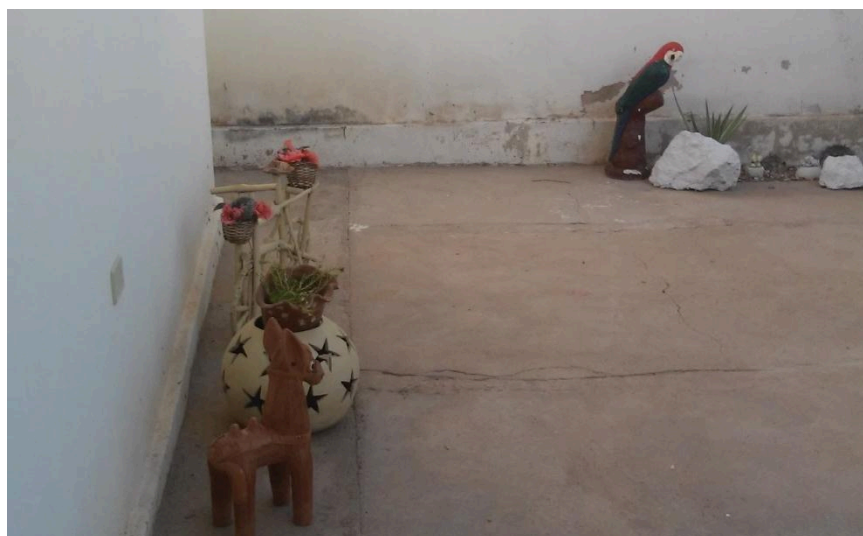
Figura 3 – Demonstração de falhas na parede na casa 02.
