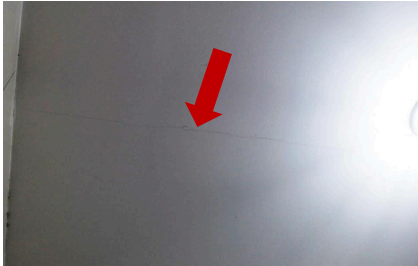
Figura 2 – Rachadura no forro da casa 01.
