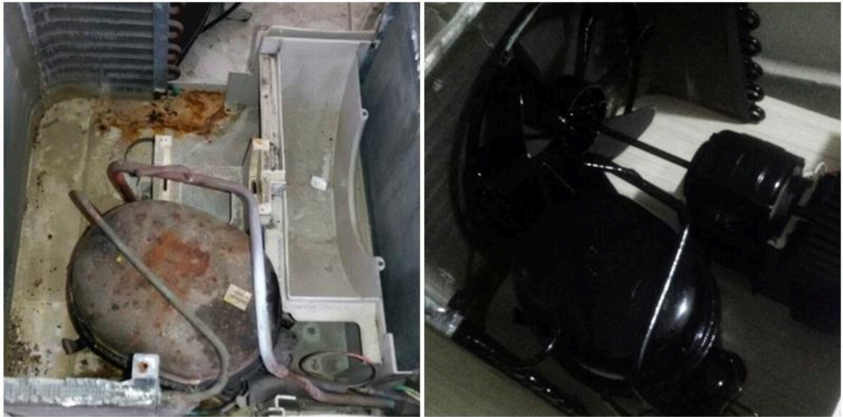
Figura 12: Aparelho após a manutenção
