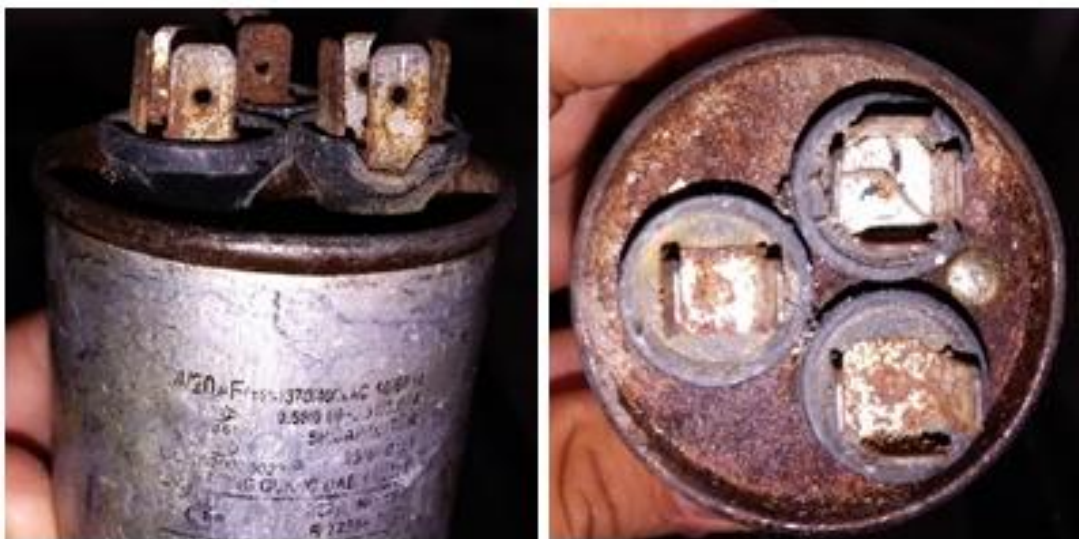
Figura 11: Degradação do capacitor
