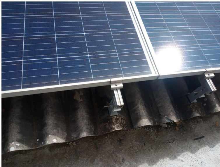
Figura 22 - Elementos de fixação da usina do IFRN, campus Pau dos Ferros
