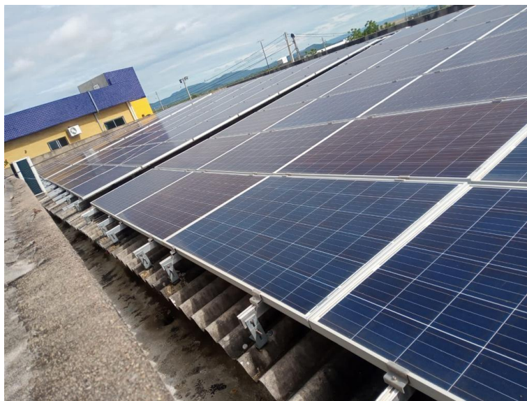
Figura 21 - Usina fotovoltaica do IFRN, campus Pau dos Ferros
