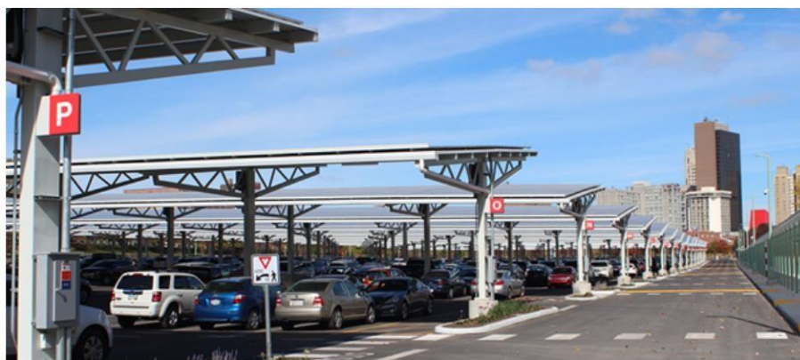
Figura 10 - Forma de instalação de usina solar em estacionamentos
