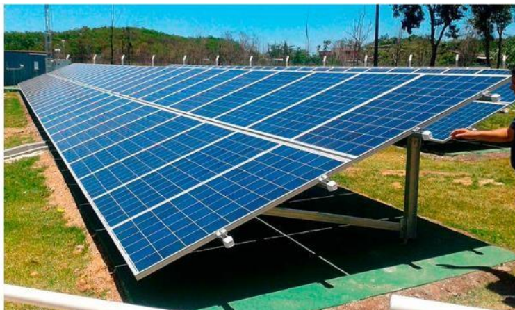
Figura 3 - Painéis em suas estruturas de fixação
