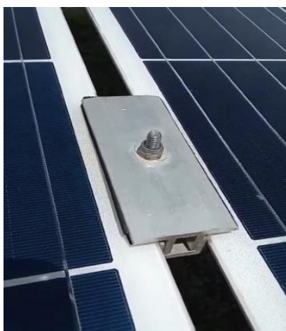
Figura 26 - - Parafuso não corroído (UFERSA, campus Pau dos Ferros)
