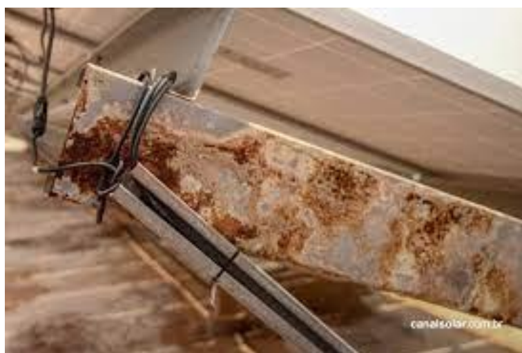
Figura 1 - Exemplo de corrosão em estruturas de usina solar
