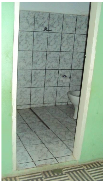
Figura 4: Porta de banheiro com largura inferior da permitida.
