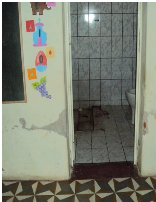
Figura 9: Porta do banheiro, com largura inferior ao permitido e com giro para dentro em desacordo com a NBR 9050 (2004).
