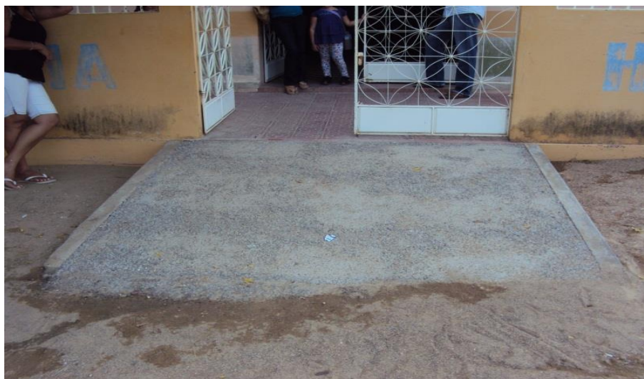
Figura 3: Rampa para acesso à instituição avança além dos limites do lote, desrespeitando a NBR 9050 (2004).
