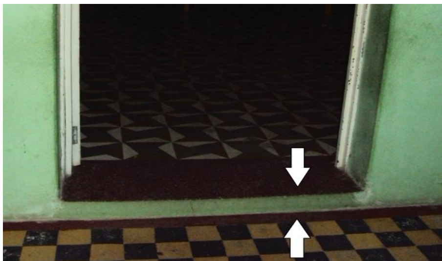
Figura 5: Desnível de 08 cm no acesso as salas de aula dificultam o acesso de alunos e funcionários.
