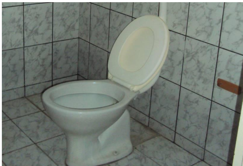
Figura 7: Bacias sanitárias dos banheiros da instituição com ausência de barras de apoio como exigido pela NBR 9050 (2004).
