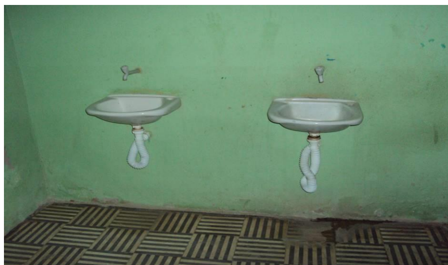
Figura 10: Lavatórios sem barras de apoio e independentes dos banheiros.
