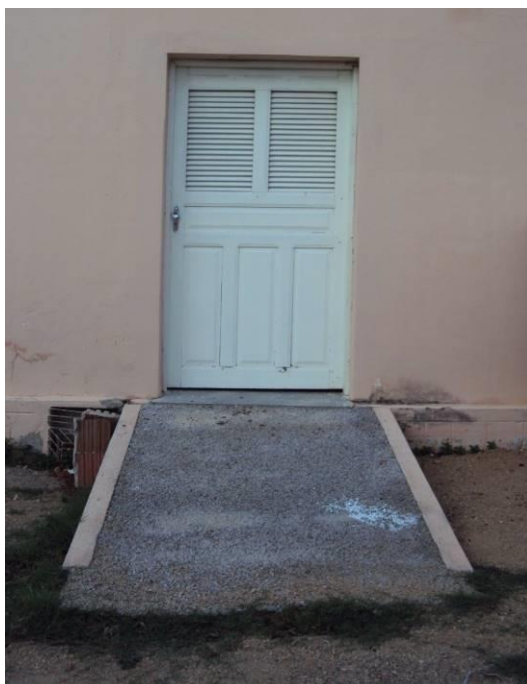
Figura 6: Rampa de acesso ao parque infantil possui largura suficiente, porém não respeita as outras exigências da NBR 9050 (2004).
