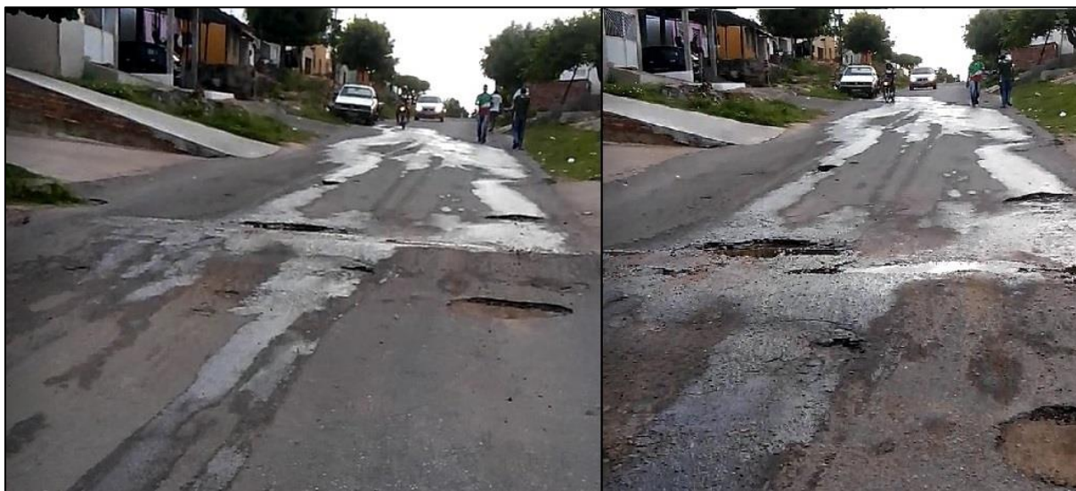
Figura 11: Pavimento muito degradado junto de uma lombada.
