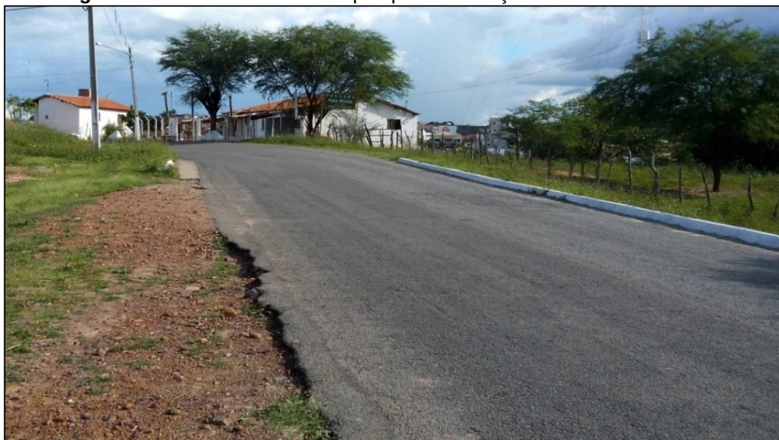
Figura 12: Curva fechada sem qualquer sinalização vertical ou horizontal.
