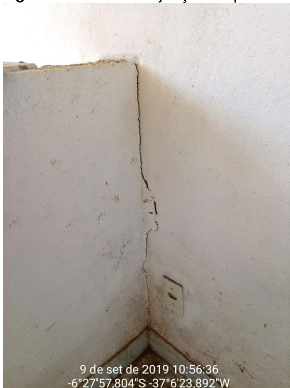
Figura 13 - Trinca na junção de paredes.
