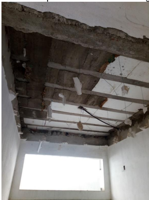
Figura 10 - Deslocamento do forro de gesso.
