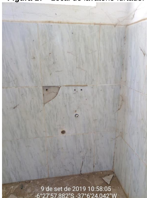
Figura 17 - Local do lavatório furtado.
