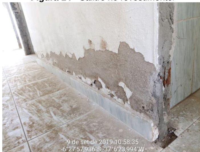
Figura 14 - Salitre no revestimento.
