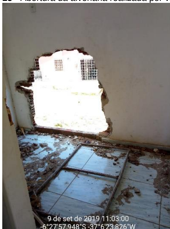
Figura 15 - Abertura da alvenaria realizada por vândalos.
