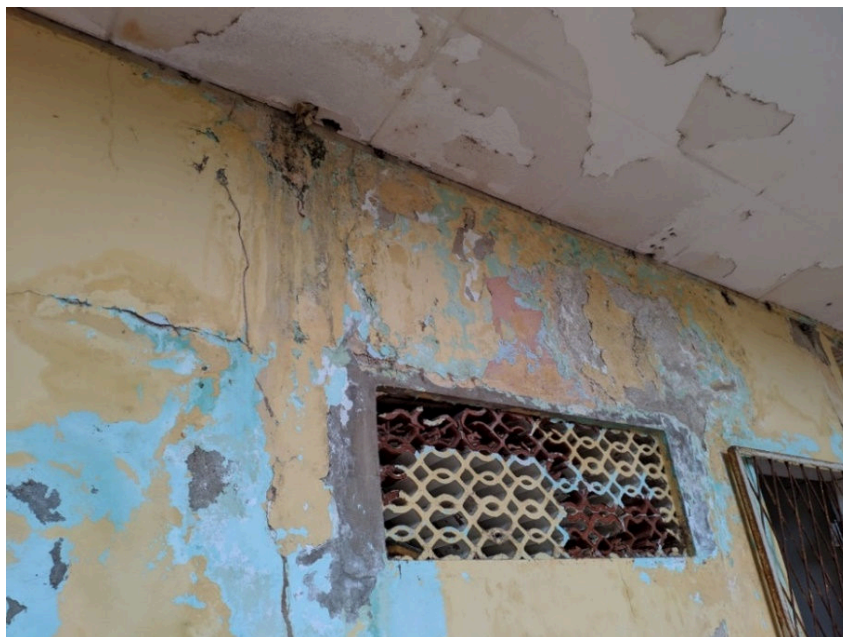
Figura 15 – Viga Vp2 com ocorrência de infiltração e corrosão das armaduras
