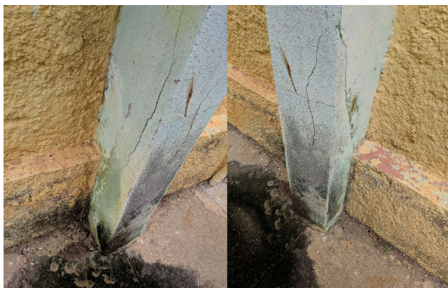
Figura 13 – Pilar P7 e o desenvolvimento de manchas de umidade
