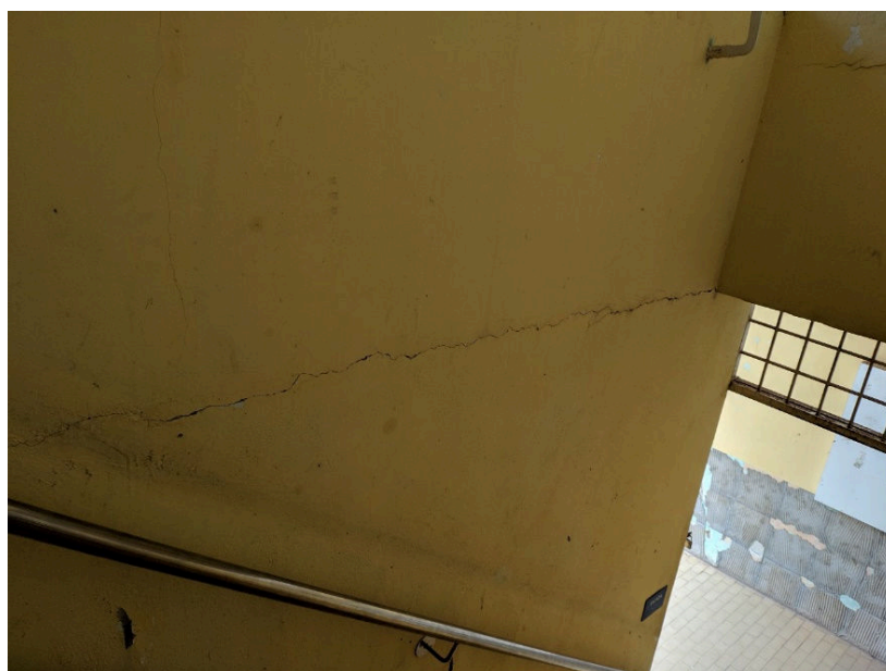
Figura 18 – Fissura na Vp4 devido a falha na execução do encunhamento da alvenaria
