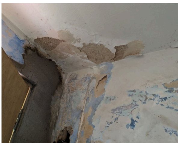
Figura 20 – Banheiro do piso superior, onde a Vs1 sofre danos quanto a infiltração
