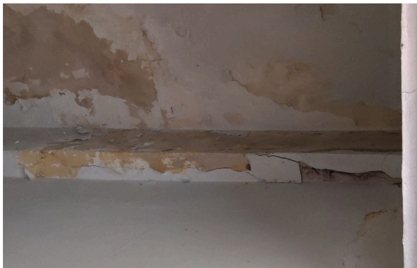
Figura 17 – Corrosão da armadura e efeitos da umidade no revestimento da Vp3
