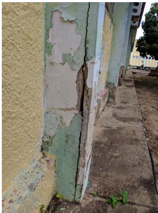
Figura 10 – Pilar, identificado como P1, apresentando deslocamento de concreto
