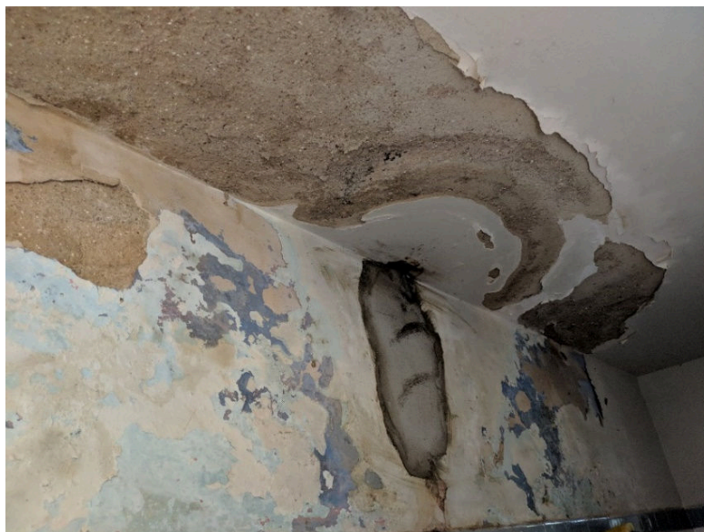
Figura 21 – Vs1 sujeita a umidades e manchas devido a infiltração
