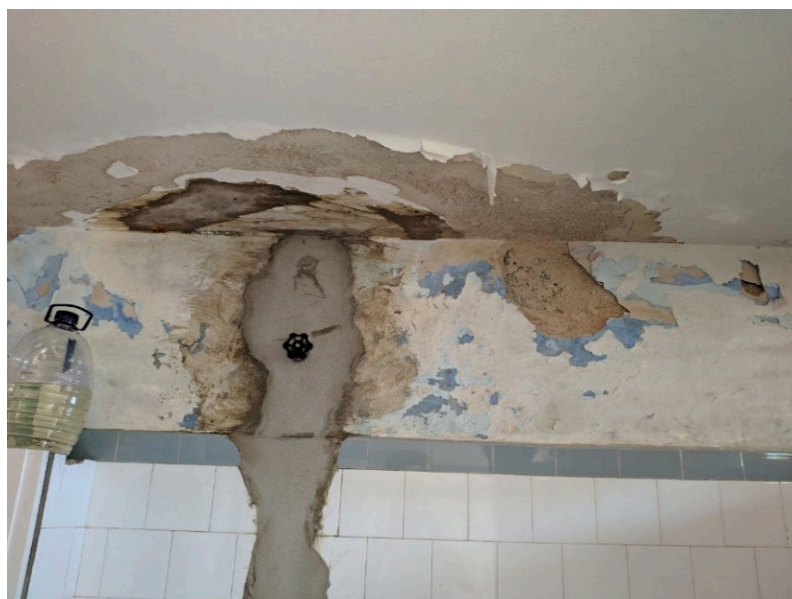
Figura 22 – O outro lado da Vs1 acometido de danos patológicos de infiltração
