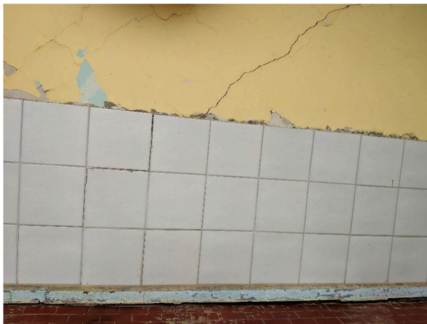
Figura 24 – Trincas diagonais na alvenaria de vedação, acompanhando as juntas de assentamento do revestimento cerâmico, indicando presença de recalque
