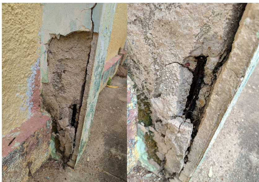
Figura 11 – Pilar P2 com armadura exposta sofrendo corrosão, como também ocorrência de deslocamento de concreto
