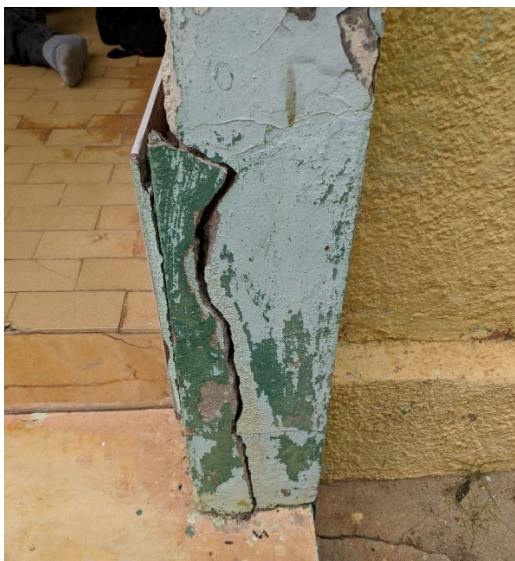
Figura 12 – Pilar P5 deslocando rente ao revestimento cerâmico
