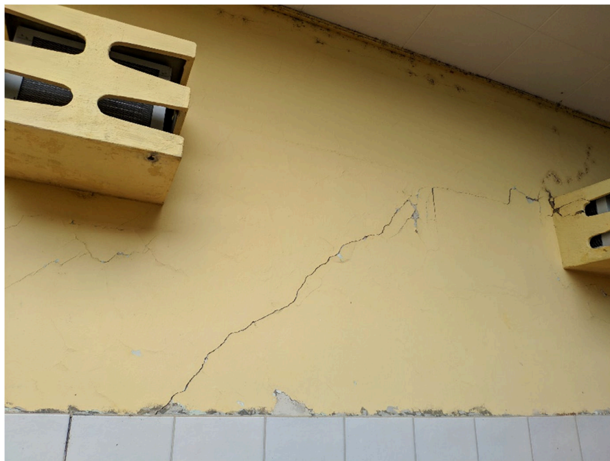
Figura 23 – Trincas diagonais na alvenaria de vedação indicando presença de recalque
