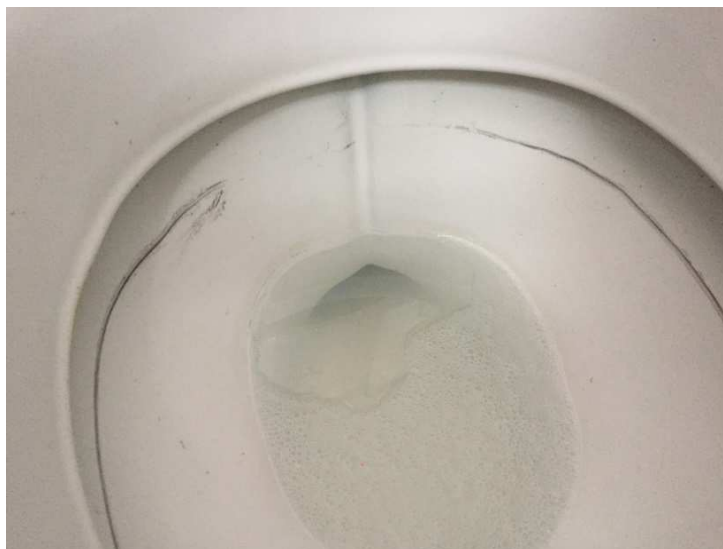
Figura 2. Detecção de vazamentos visíveis. (Autoria própria, 2019).
