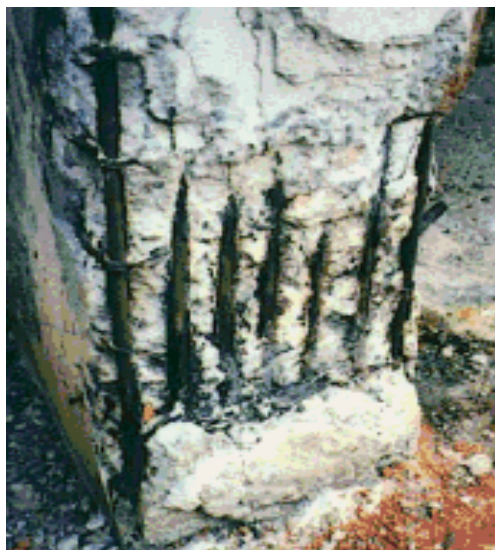
Figura 1 – Corrosão em Armaduras.
