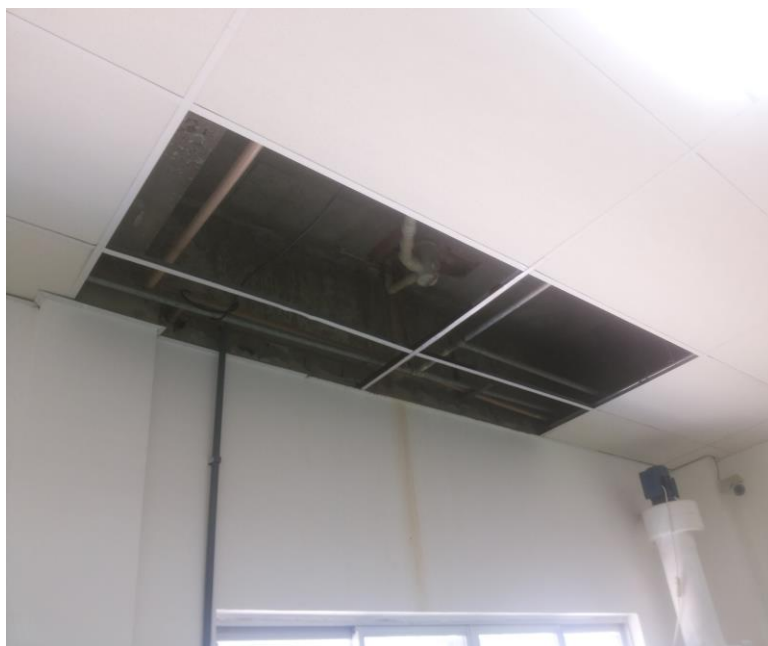
Figura 11 – Forro do Laboratório de Química Aplicada a Engenharia.
