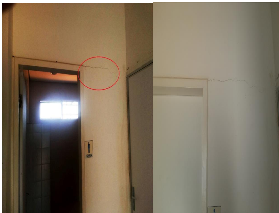
Figura 26 – Porta do banheiro masculino.
