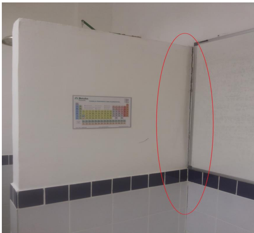
Figura 30 – Fissura entre paredes de alvenaria.
