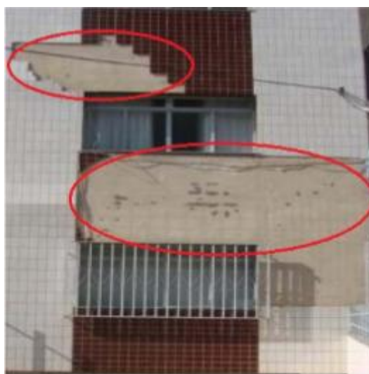
Figura 2 – Destacamento de Revestimento Cerâmico.
