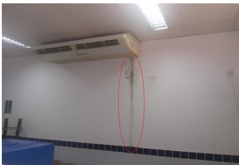
Figura 17 – Ar-condicionado do Lab. Química Aplicada.
