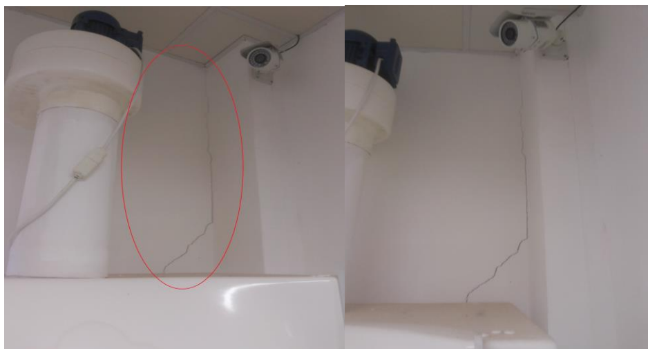
Figura 29 – Fissura entre parede e pilar.
