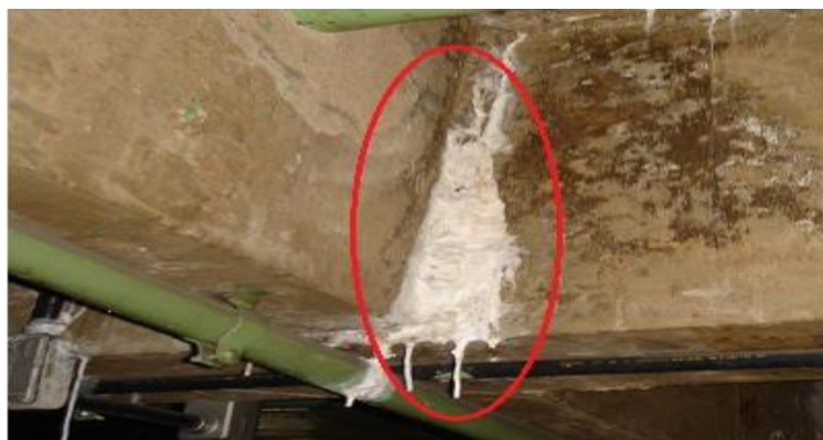
Figura 4 – Eflorescência entre vigas
