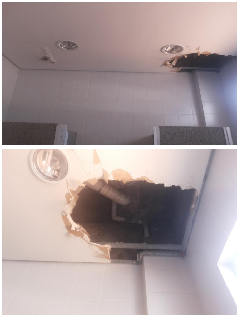
Figura 9 – Forro do banheiro feminino.
