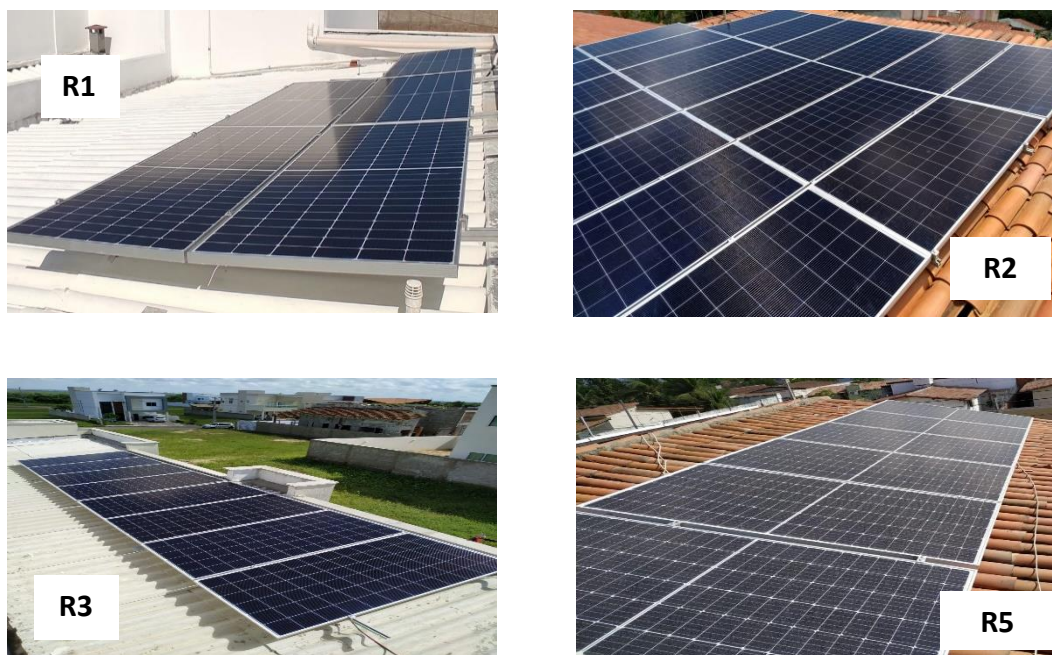
Figura 1. Placas fotovoltaicas instaladas no teto das residências R1; R2; R3 e R5 no município de Mossoró-RN (Autoria própria, 2023).
