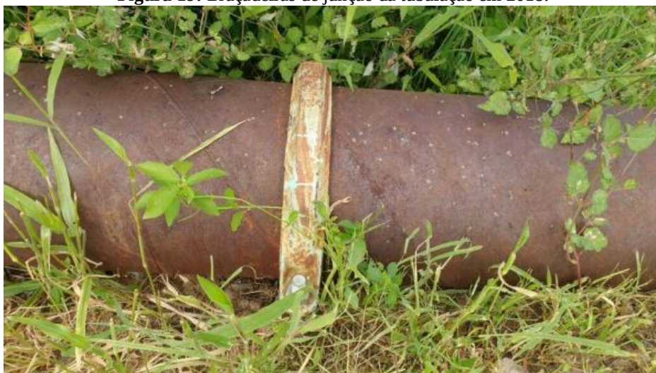
Figura 19: Braçadeiras de junção da tubulação em 2018.
