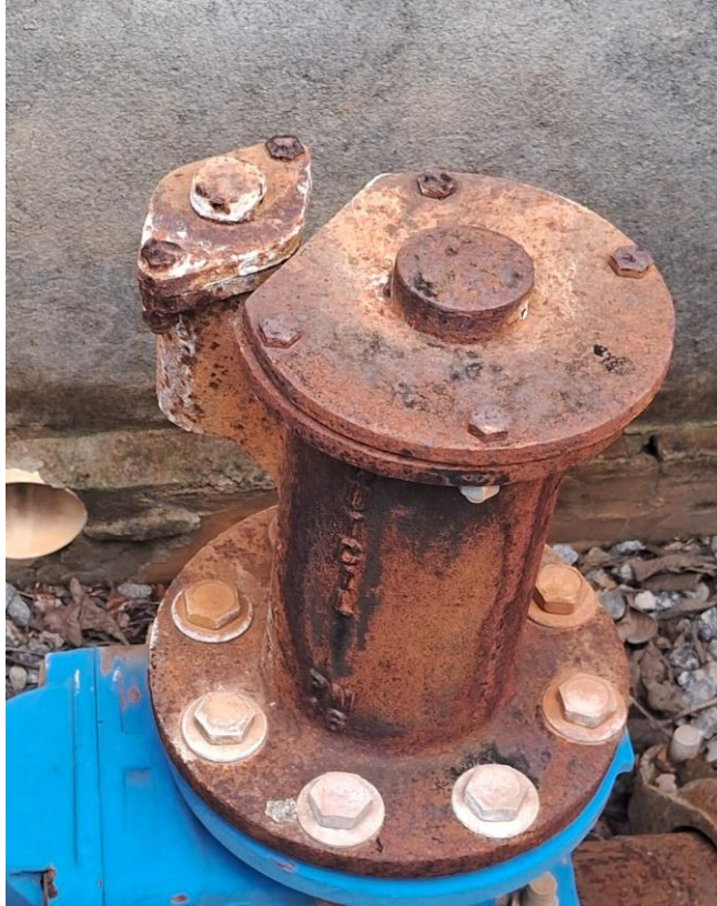
Figura 21: Válvula de gaveta da adutora de Pau dos Ferros -RN.
