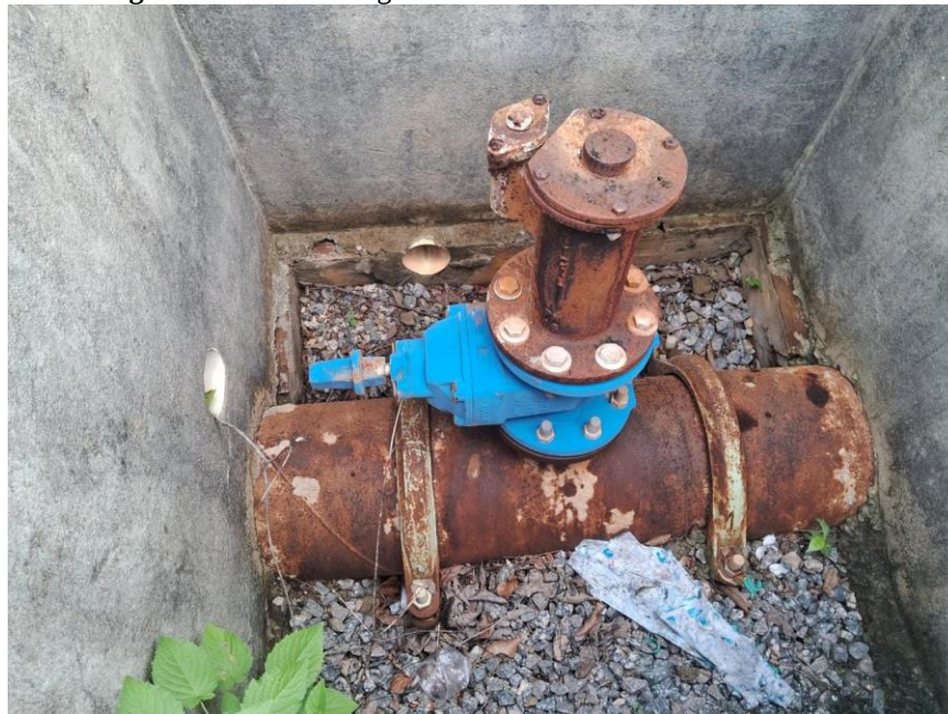
Figura 20: Válvula de gaveta da adutora de Pau dos Ferros -RN.
