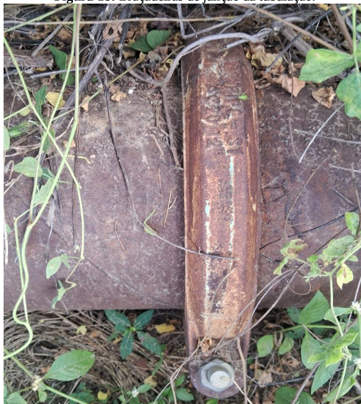
Figura 18: Braçadeiras de junção da tubulação.
