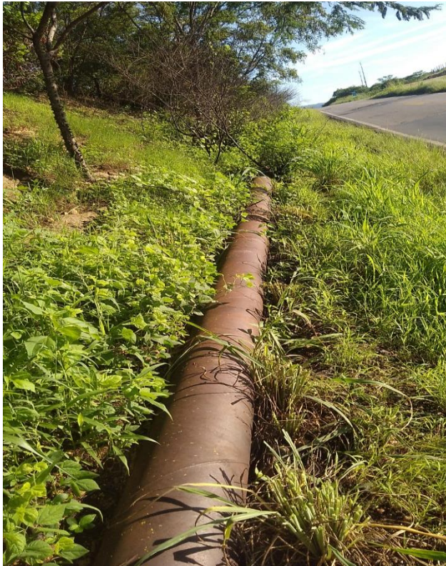
Figura 9: Dutos da adutora de Pau dos Ferros -RN sentido São Francisco do Oeste -RN.
