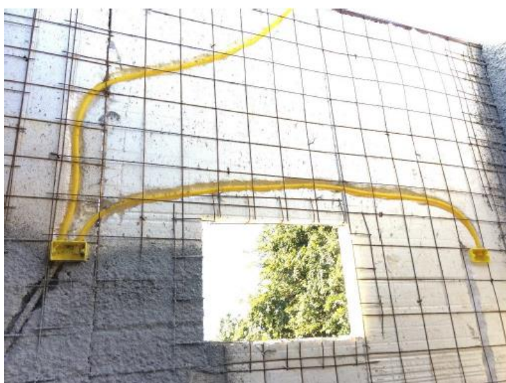
Figura 17: Instalações elétricas nos painéis
