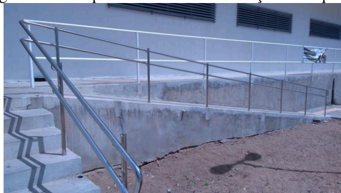
Figura 28 - Rampa executada com inclinação inadequada
