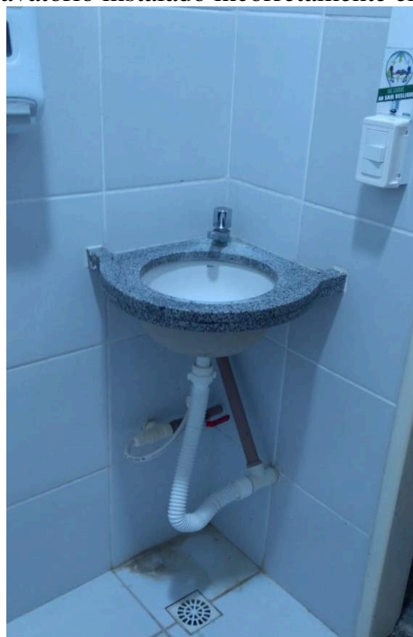
Figura 35 - Lavatório instalado incorretamente em banheiro
