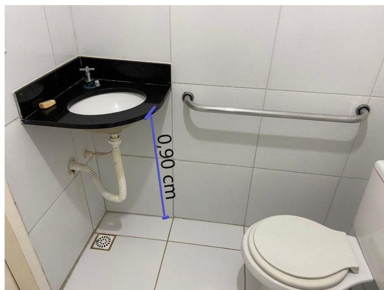
Figura 6 - Lavatório instalado de forma irregular
