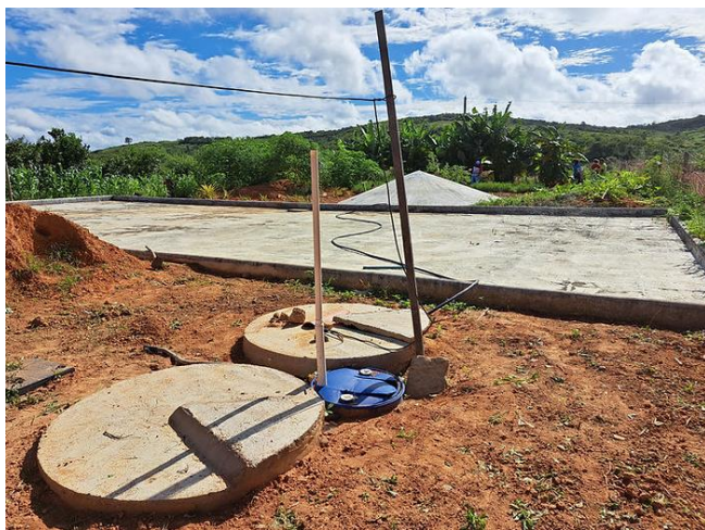
Figura02- Sistema de reuso instalado na zona rural
