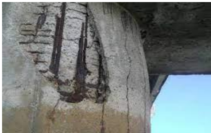
Figura 3 – Corrosão nas armaduras
