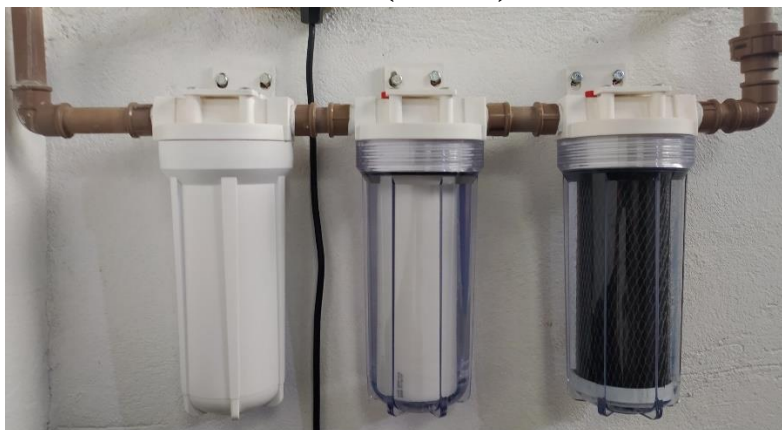
Figura 5 – Filtros de água sendo dois de quartzo (à esquerda e ao centro) e um de carvão ativado (à direita).
