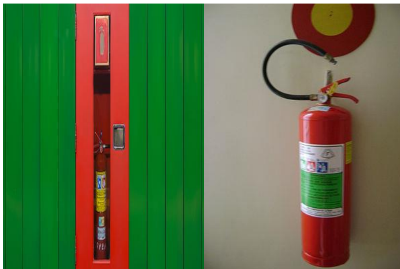
Figura 5- Posição dos extintores Fonte: Internet (2018)
