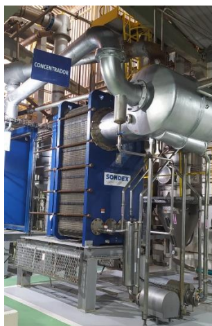
Figura 5 – Trocador de calor utilizado no processo de concentração (Autoria Própria, 2022).
