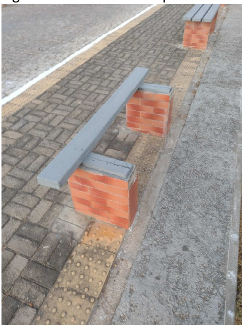
Figura 19 - Trecho Inadequado de Piso
