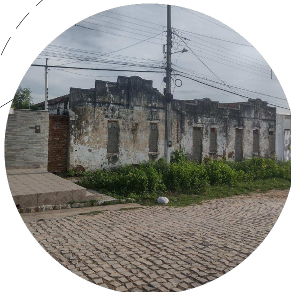
CASA EM ESTADO PRECÁRIO
