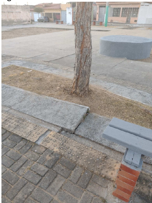
Figura 17 - Trecho Com Piso Danificado
