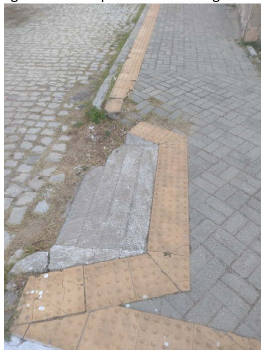
Figura 18 - Rampa de Acesso Desgastada
