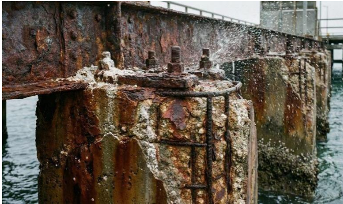
Figura 8- Corrosão causada por cloretos
