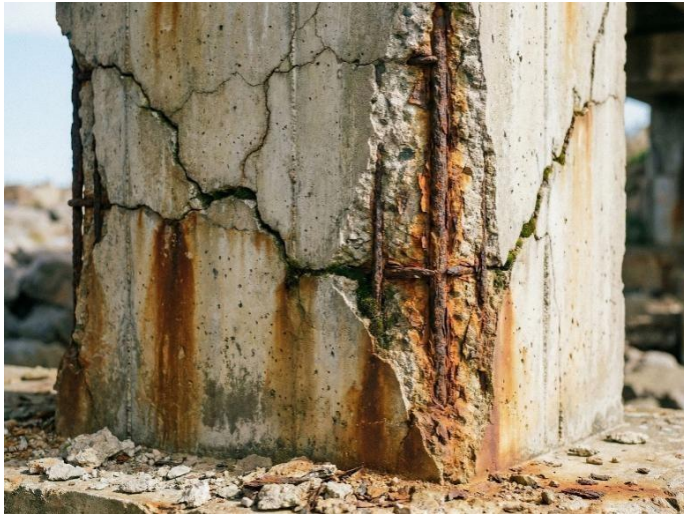
Figura 6- Corrosão no concreto armado
