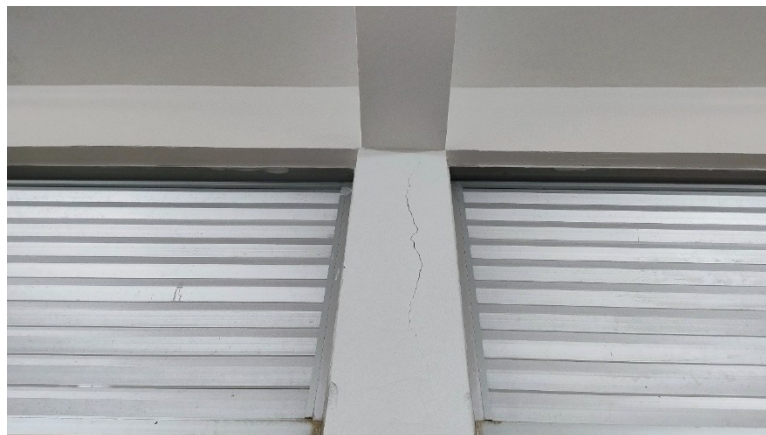
Figura 13 – Trinca no pilar da sala 5.
