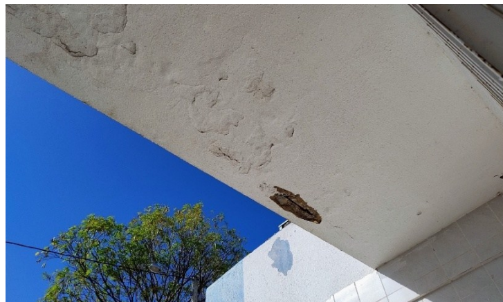
Figura 18 – Armação exposta da marquise da área externa do bloco.
