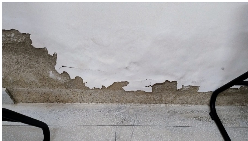
Figura 10 – Salitre no rodapé da sala de aula 2.
