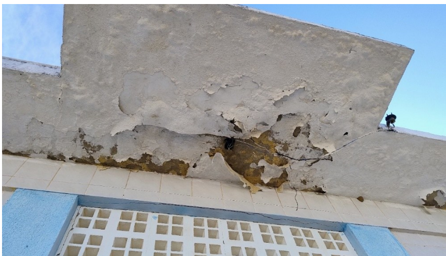
Figura 7 – Marquise da área externa do bloco com viação elétrica exposta.
