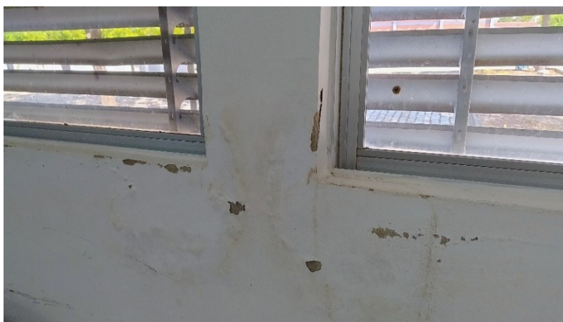
Figura 5 – Mancha de umidade na sala de aula 10.
