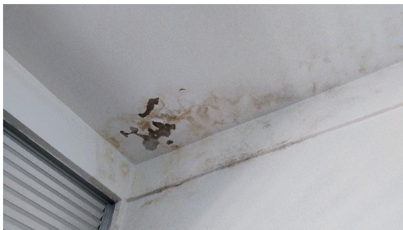
Figura 6 – Mancha de umidade na sala de aula 11.
