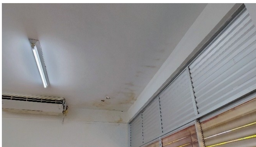
Figura 4 – Manchas de umidade na sala de aula 8.
