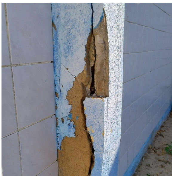
Figura 15 – Trinca no pilar externo da Central de Aulas II.
