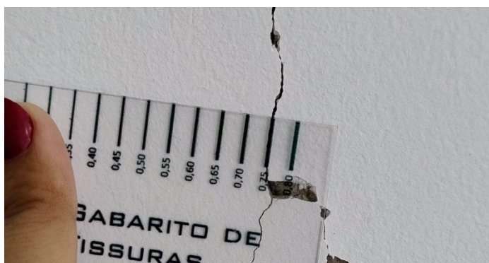
Figura 12 – Medição com fissurômetro da fissura da junta de dilatação.
