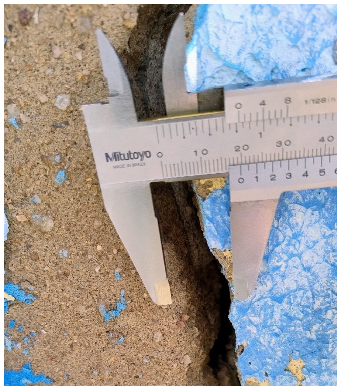
Figura 16 – Medição com paquímetro da brecha no pilar.
