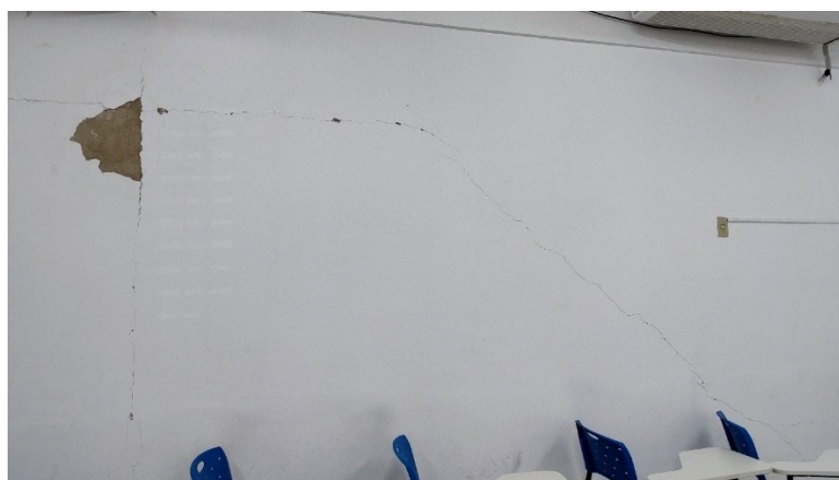
Figura 19 – Fenda característico de recalque diferencial da sala de aula 5.
