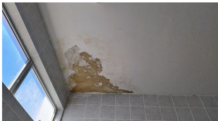
Figura 9 – Eflorescência presente no forro do banheiro feminino.
