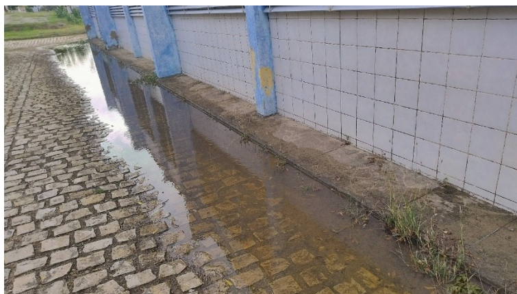
Figura 8 – Área externa da Central de Aula II após uma chuva.
