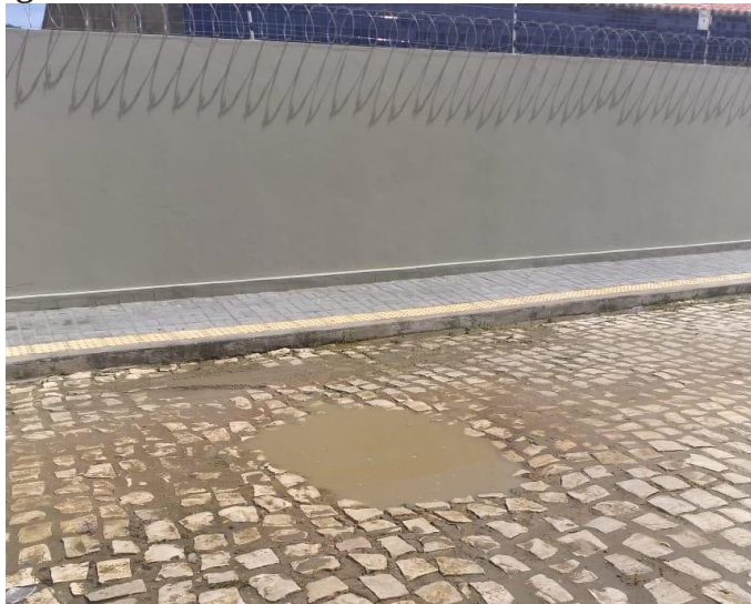
Figura 11 – Buraco na Rua Francisco André de Moraes.
