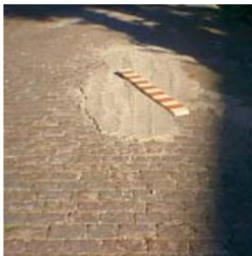
Derrame de material
