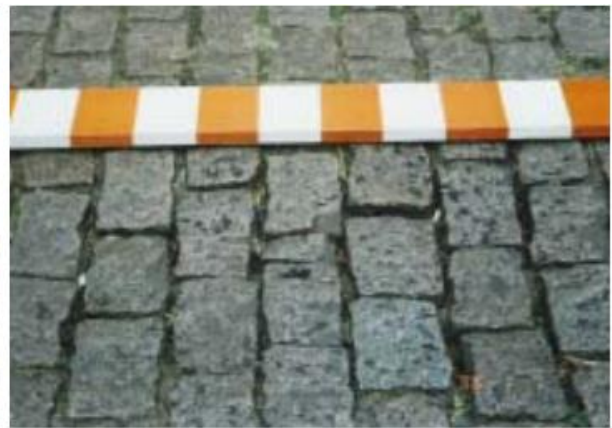
Peças trincadas ou quebradas
