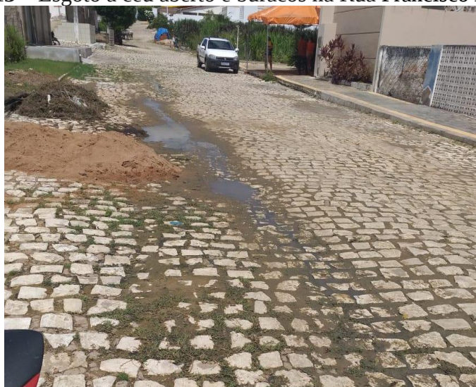
Figura 13 – Esgoto à céu aberto e buracos na Rua Francisco André de Moraes.
