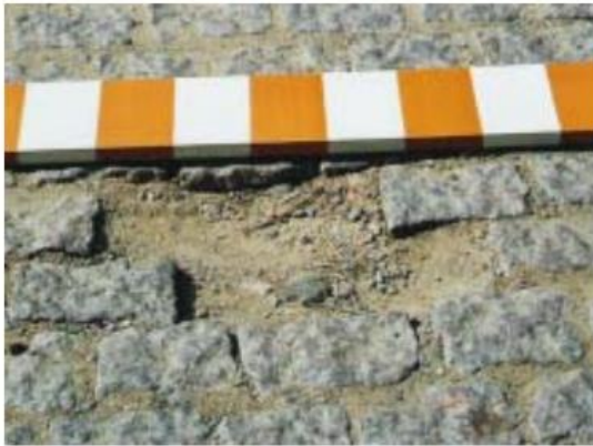
Buraco ou panela
