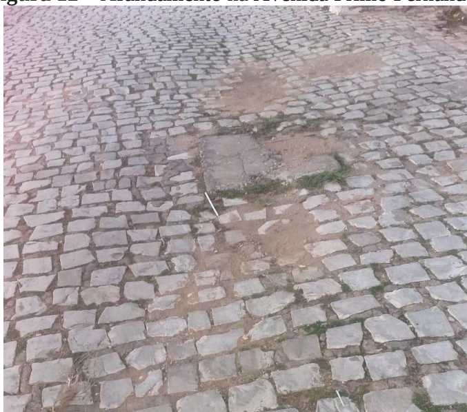
Figura 12 – Afundamento na Avenida Primo Fernandes.
