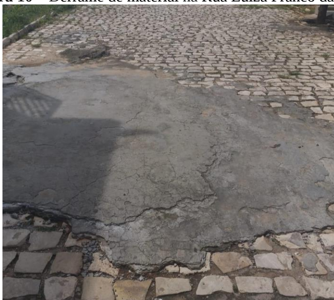
Figura 10 – Derrame de material na Rua Luiza Franco da Silva.
