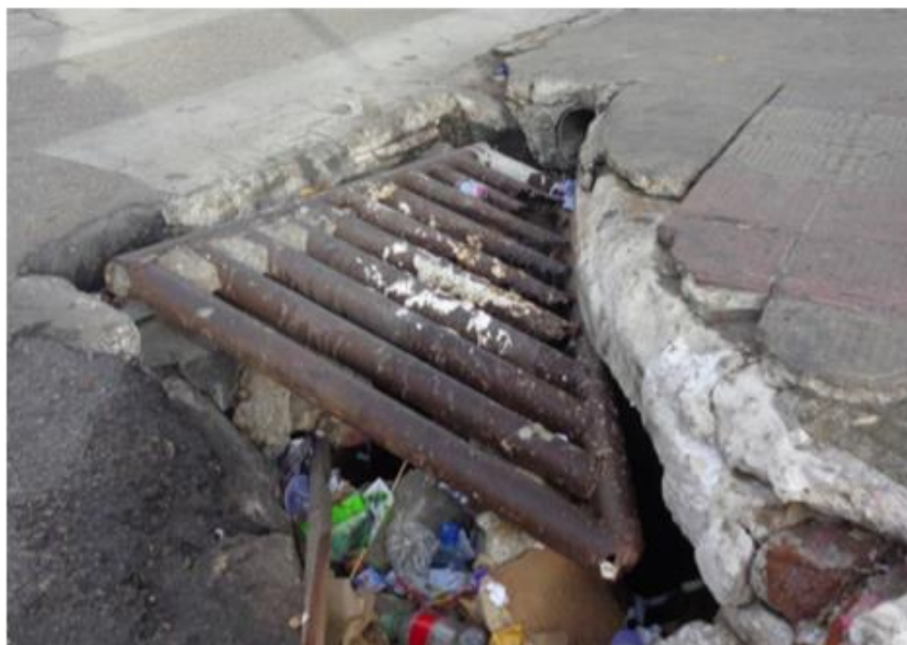
Figura 14 - Grelha corroída R. Cel. Gurgel com Alfredo Fernandes.
