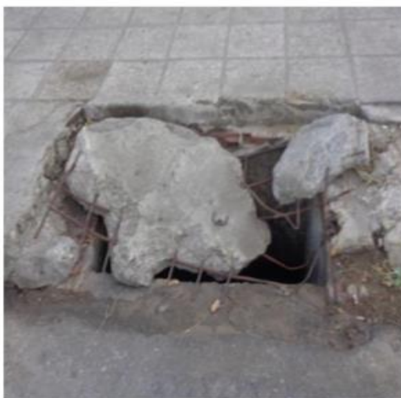
Figura 13 – Boca de lobo quebrada.
