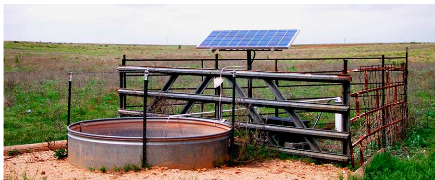
Figura 2: Sistema de bombeamento fotovoltaico
