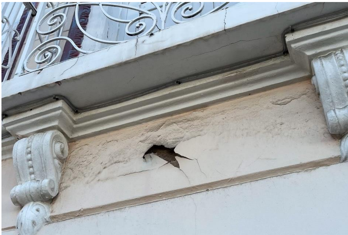
Figura 52: Argamassa solta; Sujidades; Fissuras;
