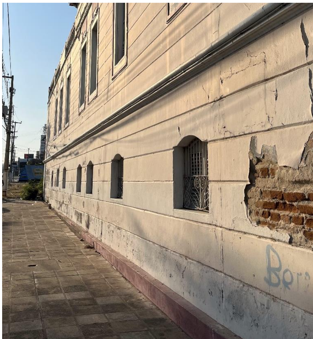
Figura 53: Lacunas; Sujidades; Fissuras; Destacamento de Pintura;
