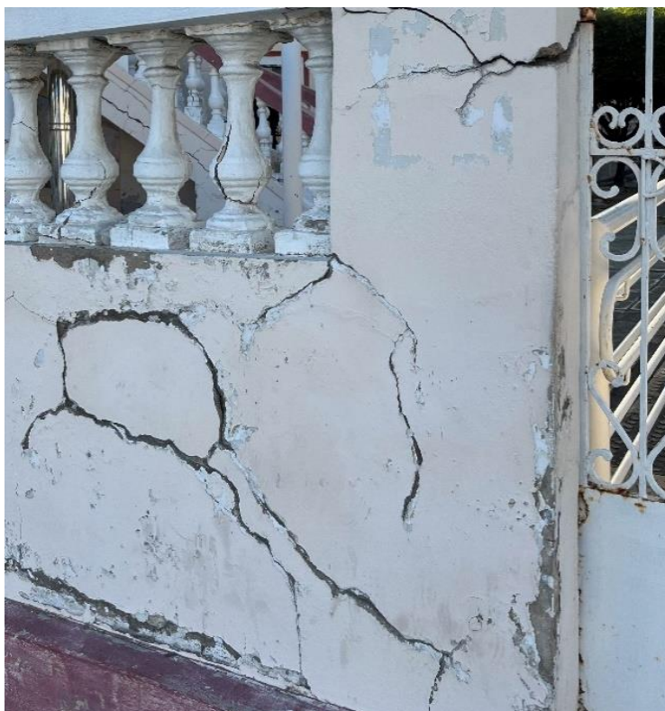
Figura 32: Rachaduras na Fachada Frontal
