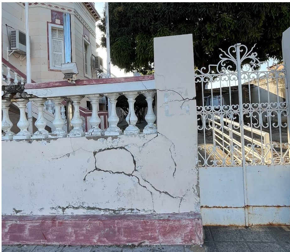
Figura 51: Fissuras; Lacunas; Ferrugem;
