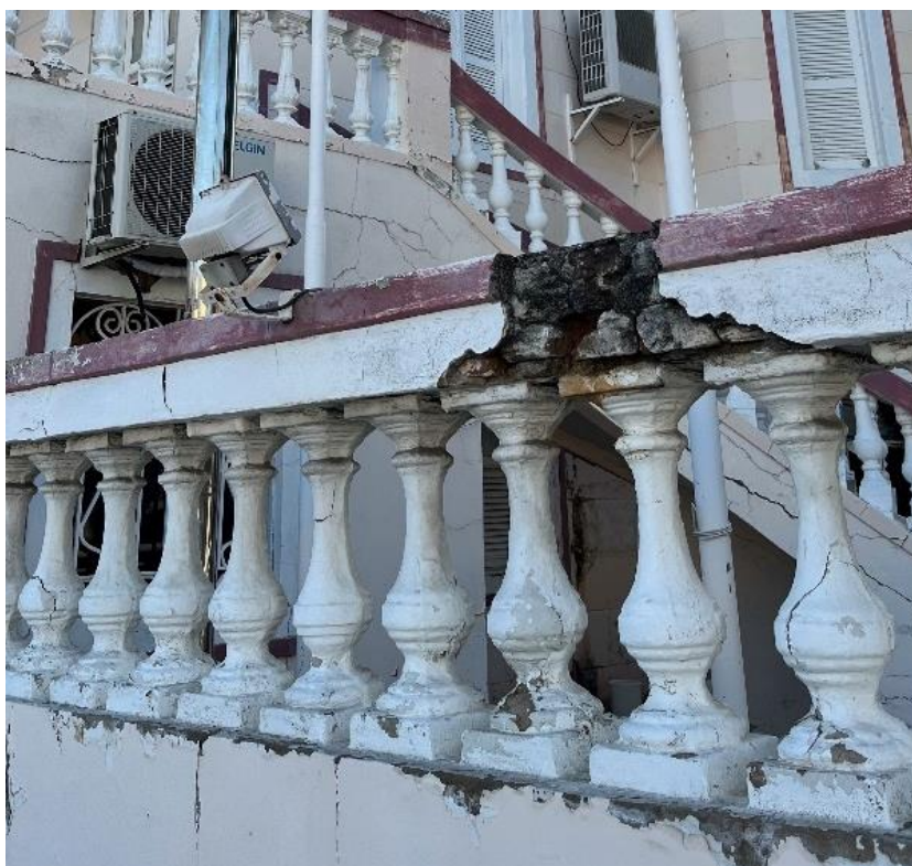
Figura 35: Patologias no Balaústres
