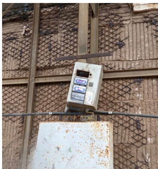
Figura 14b – Painel medidor do forno
