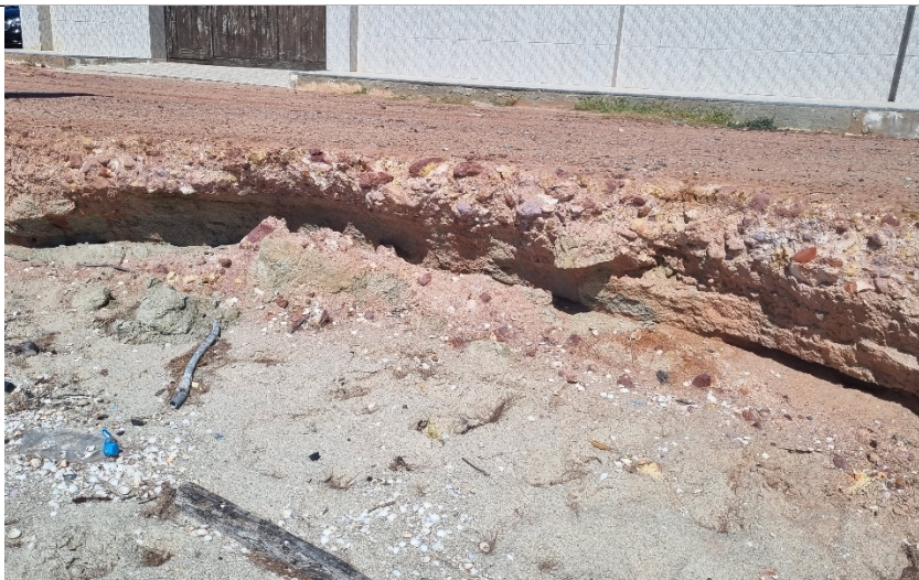
Figura 7. Sinais de erosão próximo a residências. (Autoria Própria)
