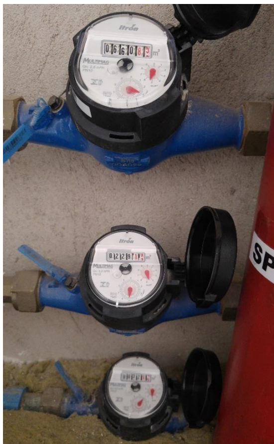
Figura 8 - Hidrômetros instalados nos pavimentos
