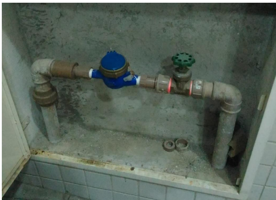
Figura 10 - Quadro com hidrômetro geral
