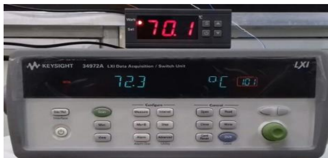
Figura 17- Estabilização das temperaturas no controlador e na unidade de aquisição
