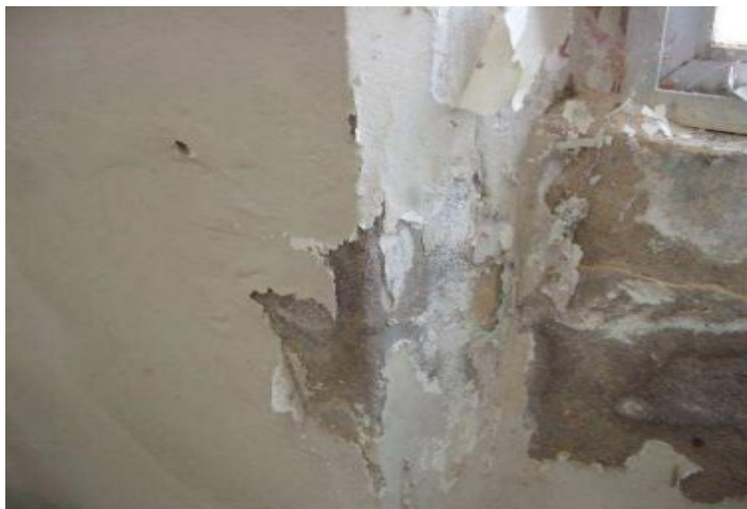
Figura 18: Disgregação em concreto armado.
