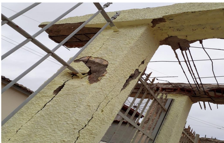
Figura 28: Desabamento de estrutura de concreto armado, após 60 dias.
