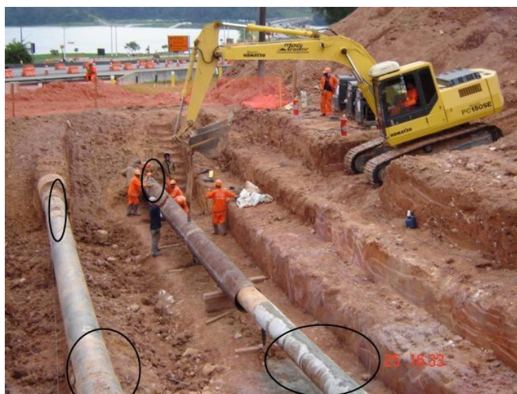
Figura 3: Corrosão eletrolítica em gerada por corrente de fuga.
