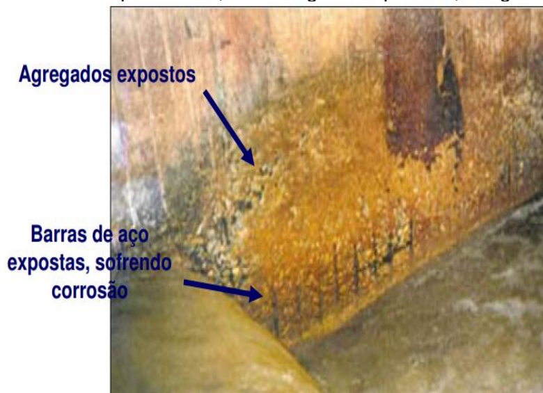
Figura 14: Corrosão por erosão, com desgaste superficial, em galeria de água.
