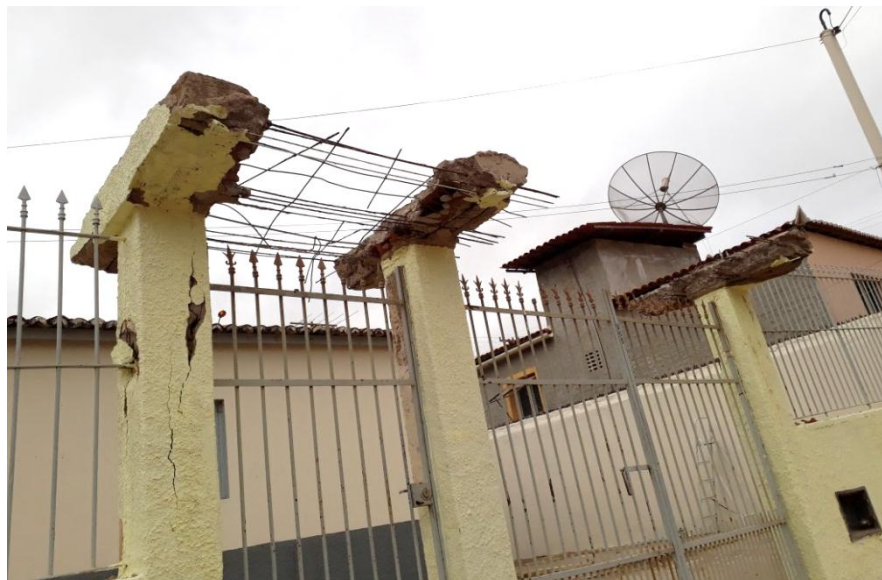
Figura 27: Desabamento de estrutura de concreto armado, após 60 dias.
