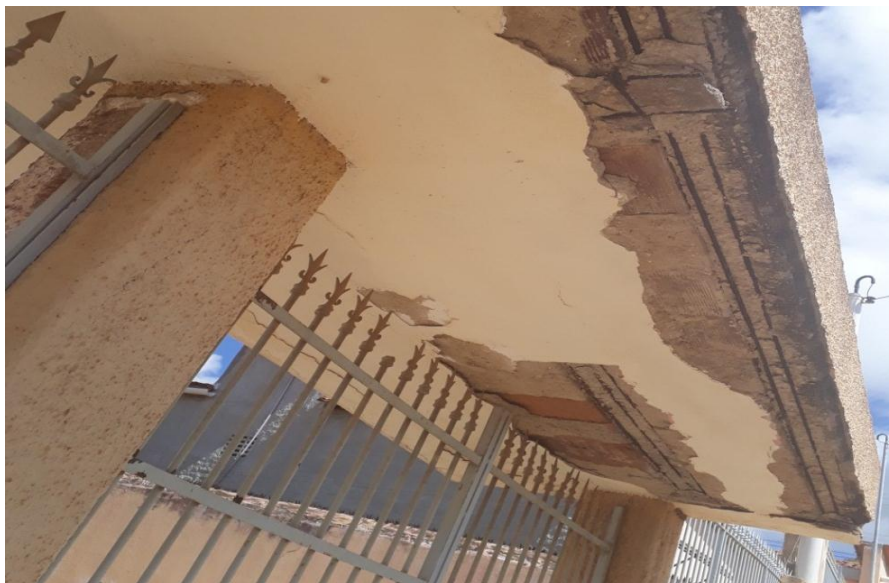
Figura 25: Estado anterior ao revestimento, 30 dia antes.
