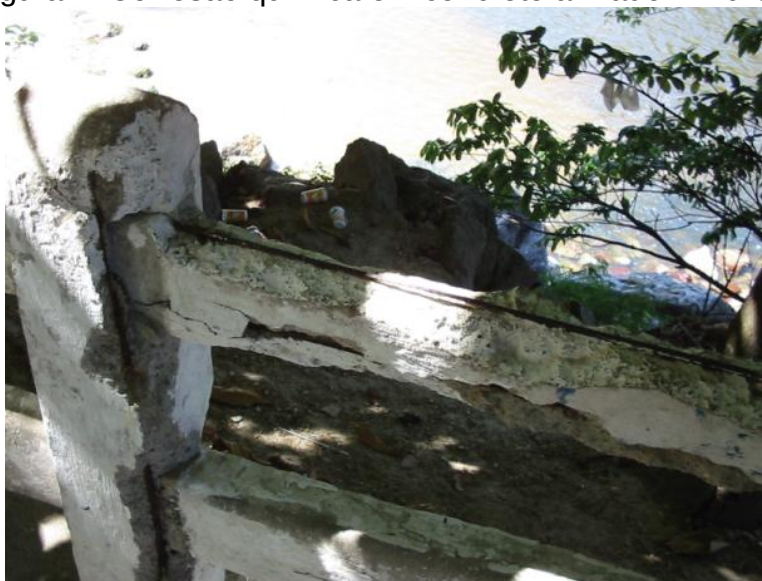
Figura 1: Corrosão química em concreto armado – mureta.
