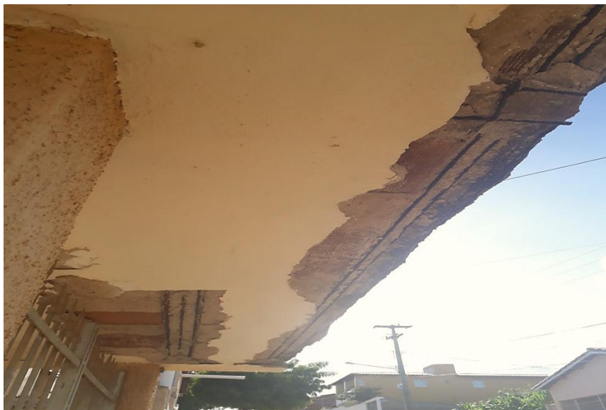
Figura 24: Armadura de concreto armado em estado de deterioração.
