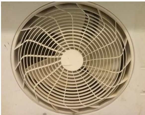
Figura 12 - Ventilador da condensadora
