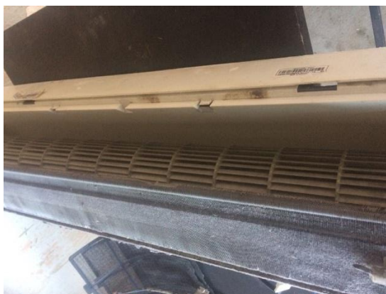
Figura 10 - Turbina do motor ventilador da evaporadora
