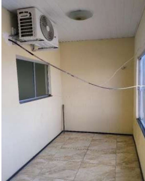
Figura 9 - OPP3: Ar condicionado Dreno conectado
