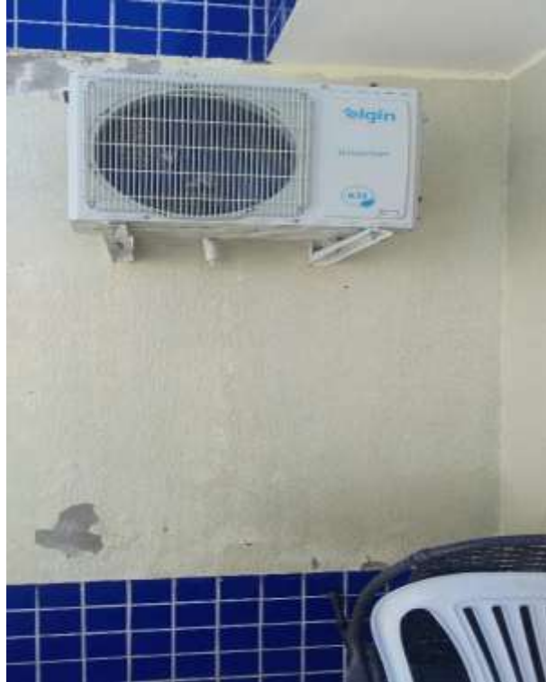
Figura 12 - OPP5: Ar condicionado e dreno
