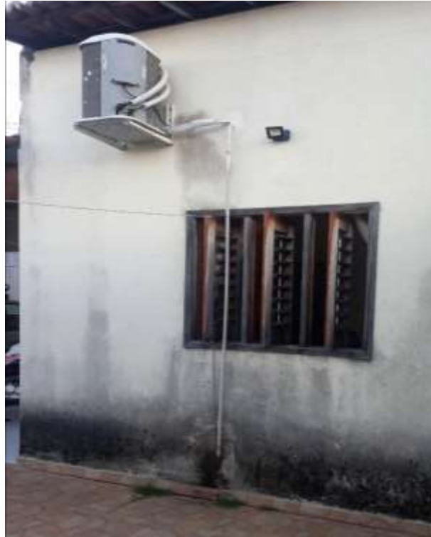
Figura 3 - OPP1: Ar condicionado 1 Dreno e lodo causado por sua água
