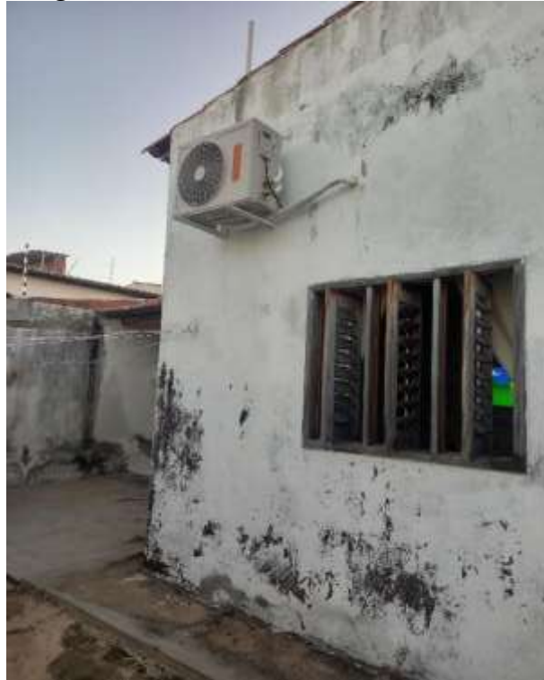
Figura 4 - OPP1: Ar condicionado 2 Dreno
