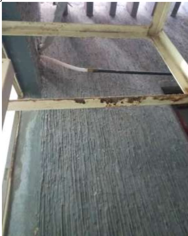
Figura 5 - OPP2: Ar condicionado 1 Dreno conectado
