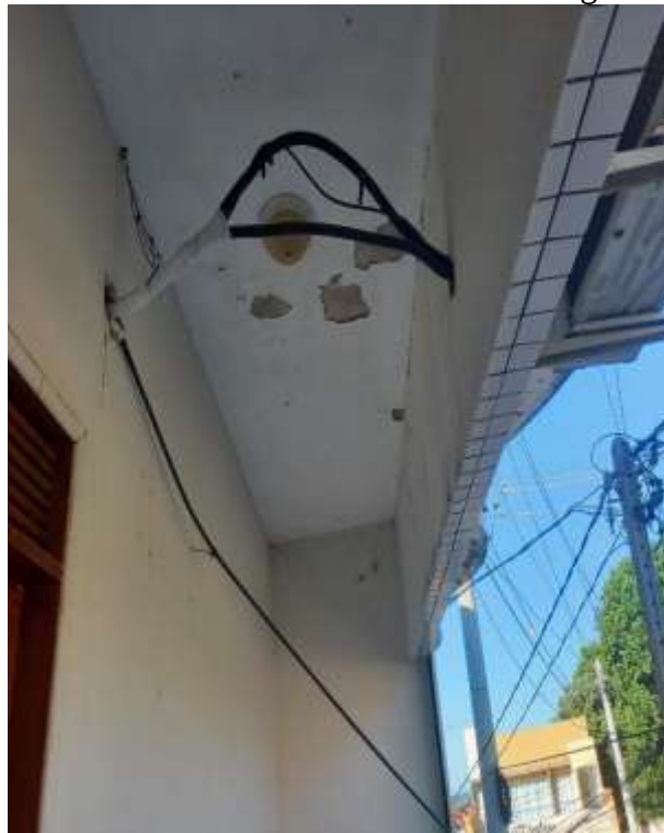
Figura 8 - OPP2: Ar condicionado 2 Dreno conectado com água caindo em via pública
