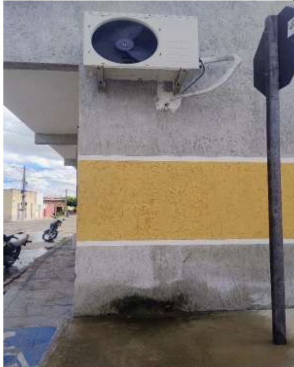
Figura 11 - OPP4: Ar condicionado, dreno e lodo causado por sua água
