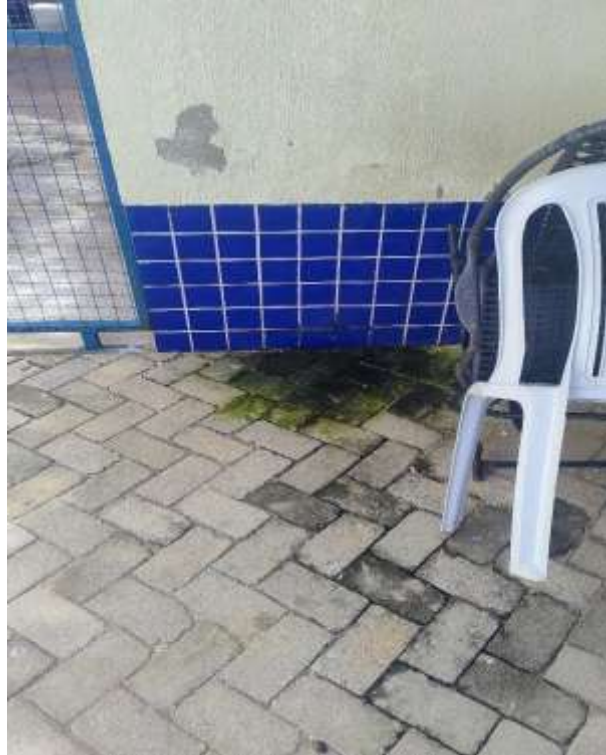
Figura 13 - OPP5: Lodo causado pela água do dreno
