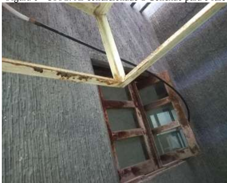
Figura 6 - OPP2: Ar condicionado 1 Conexão para o ralo
