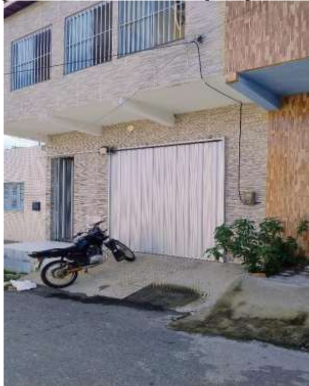
Figura 10 - OPP3: Lodo causado pela água do dreno
