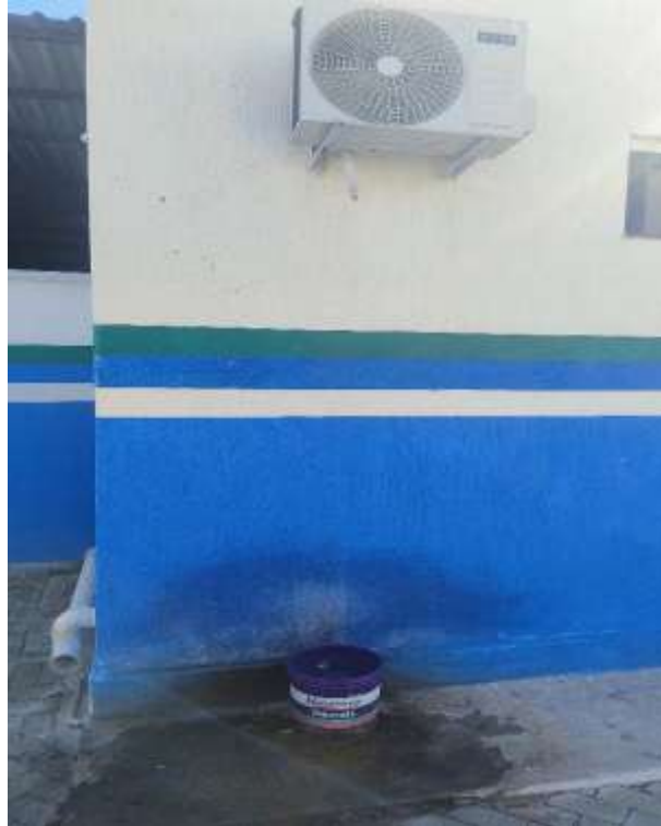
Figura 16 - OPP6: Ar condicionado 2 Lodo causado pela água do dreno
